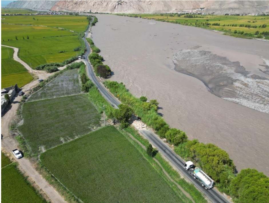
Fotografía 13. Aumento de caudal del río Ocoña, que ocasiona erosión fluvial en la carretera que se encuentra al margen del cauce del río.
