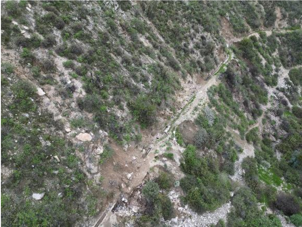
Fotografía 25. Vista aérea de las vías afectadas por derrumbes en el sector de Ispacas – Yanaquihua, donde predominan laderas inestables.
