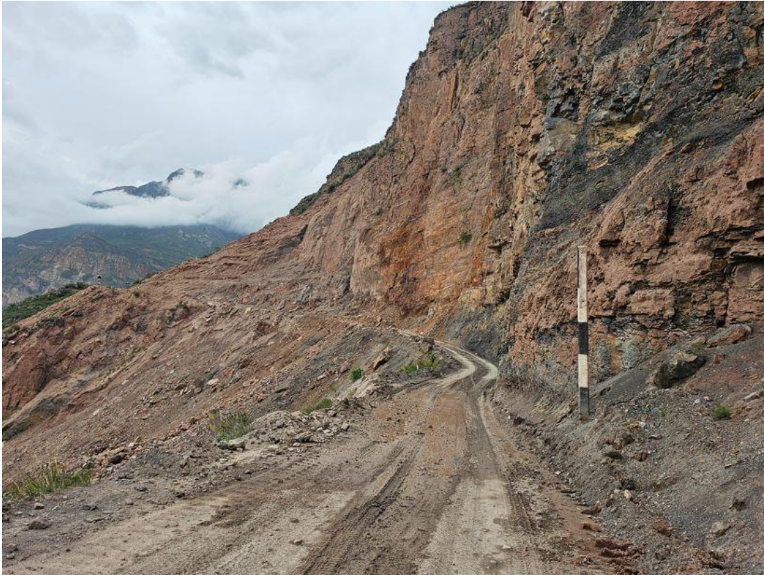
Fotografía 31. Sector tramo de la carretera de Cotahuasi a Charcana, afectado por caída de rocas. Se distingue corte de taludes inestables con rocas fracturadas.
