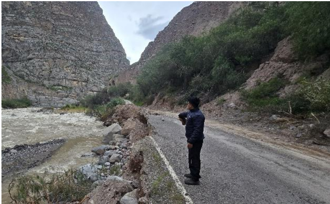
Fotografía 32. El incremento del río Cotahuasi, afectó tramo de la carretera de Cotahuasi hacia la catarata de Sipia, causando erosión fluvial en parte de la plataforma de esta vía.
