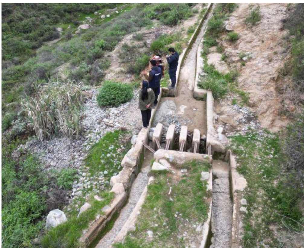
Fotografía 24. Canal principal de regadío en el sector de Ispacas, afectado por los flujos de detritos.
