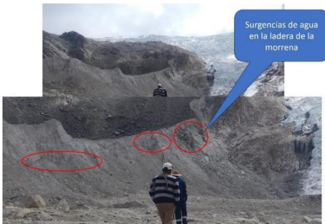
Figura 6. Se aprecian surgencias de aguas en la ladera sur oeste de la morrena.
