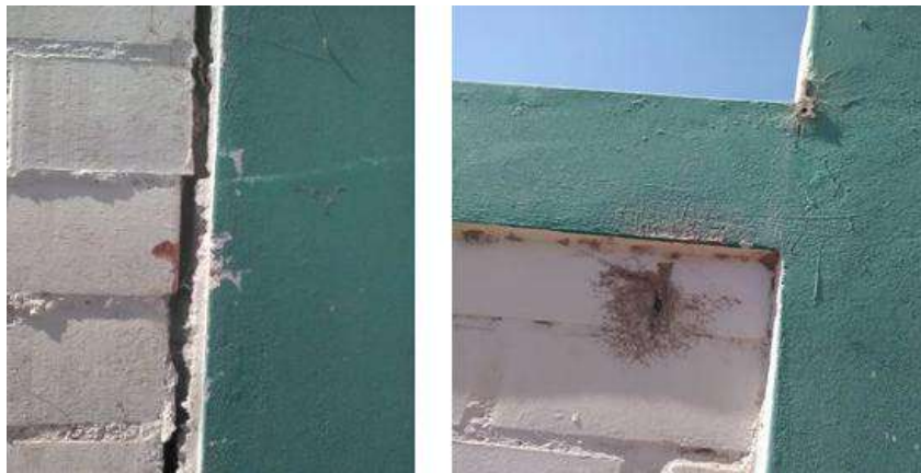
El cerco perimétrico es de 143.20m aprox. da colindancia con la Av. Principal asimismo se observó que entre el paño 3 y 4 con una grieta muy pronunciada de 2 cm. Que separa la columna del bloque de ladrillos dejando al muro muy inestable.
