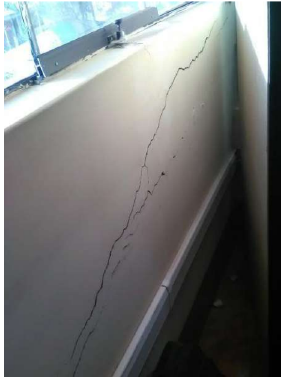
Fisura vertical en muro, se presume por mal desenvolvimiento de junta de dilatación.
