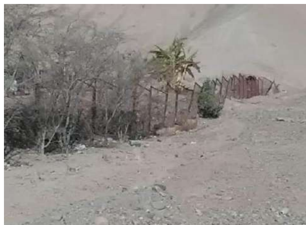
El cerco con bastidores y malla tejida metálica, los bastidores se encuentran en pésimo estado de conservación, tiene inestabilidad en muchos de sus tramos con el peligro de caer, tiene sectores abollados otros por su poca sujeción al suelo se encuentra totalmente
