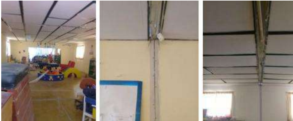
Desprendimiento de uniones de tuberí de la instalación del espacio de Ludoteca y exposición eléctrica
