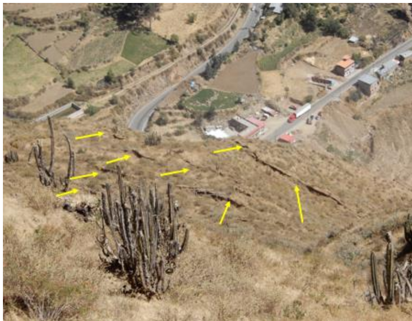
Figura 16. Se aprecian los agrietamientos frescos sobre el terreno inestable (señalados con líneas amarillas).
