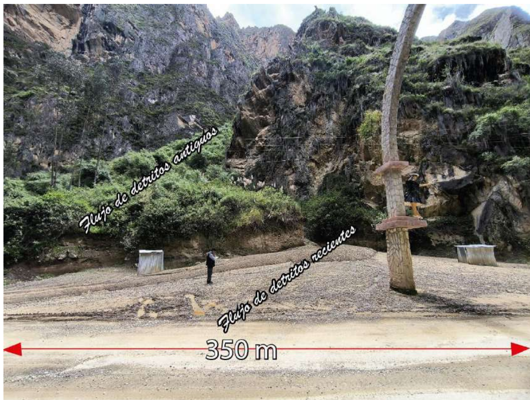
Figura 17. Tramo de la carretera afectado en el sector 3 por flujo de detritos en el área de estudio.
