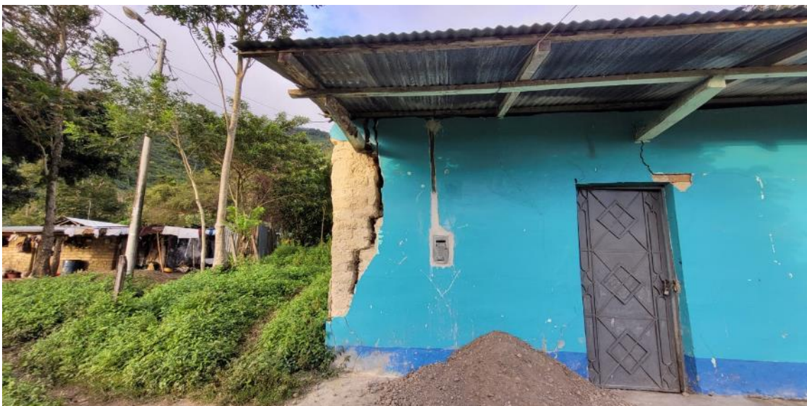
Fotografía 5. Estructura dañada de la escuela de nivel inicial no escolarizado del Mel.
