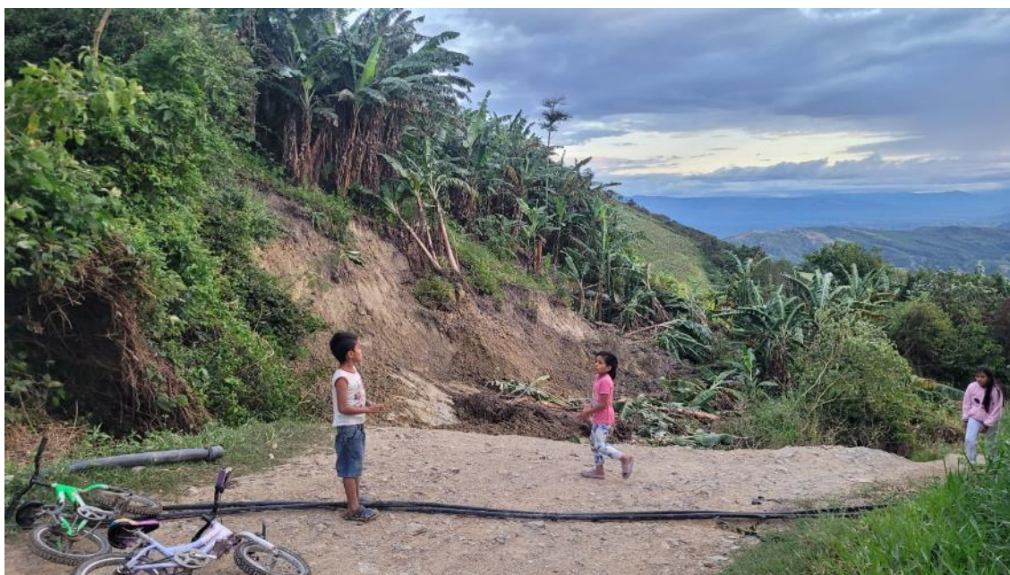
Fotografía 7. Tramo de 106 m de la vía de acceso hacia El Mel debido al deslizamiento DR-aM2.
