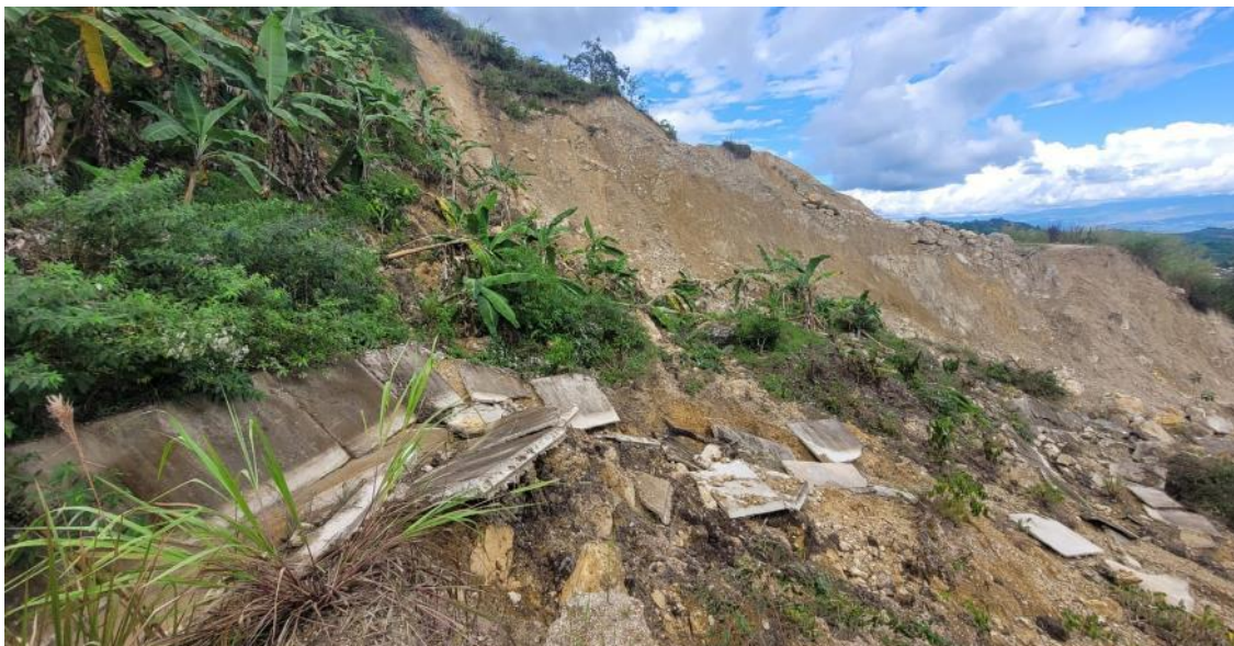
Fotografía 9. Canal La Peca en el caserío Churiaco, afectado por el deslizamiento DR-aCH2.
