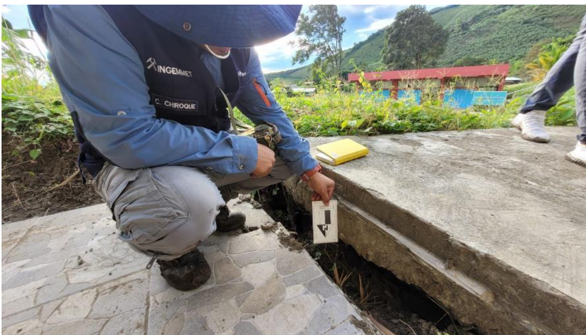
Fotografía 6. Vivienda afectada en el caserío Puente Piedra.
