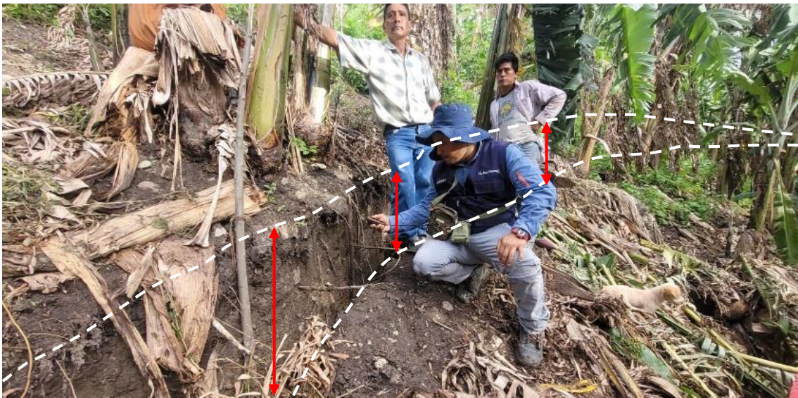
Figura 18. Escarpe de deslizamientos rotacional activo DR-aM1 en el caserío Mel.
