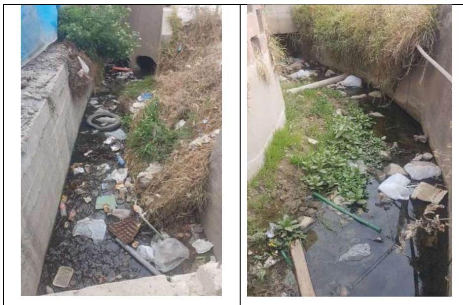
Figura N° 4. Contaminación del agua en Colquamarca
