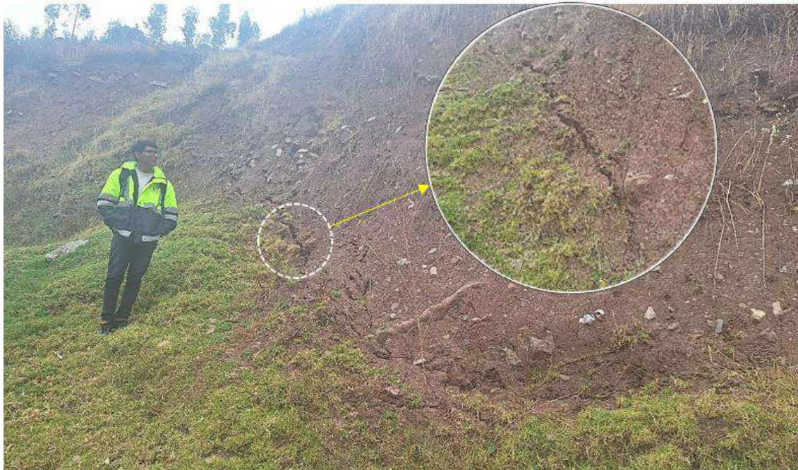
Figura N° 23. Vista de agrietamientos longitudinales producidos en la base del escarpe del deslizamiento D3
