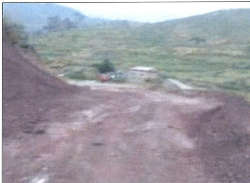
Fotografía 16. Deslizamiento en la Comunidad de Carhua, distrito de Lachaqui
