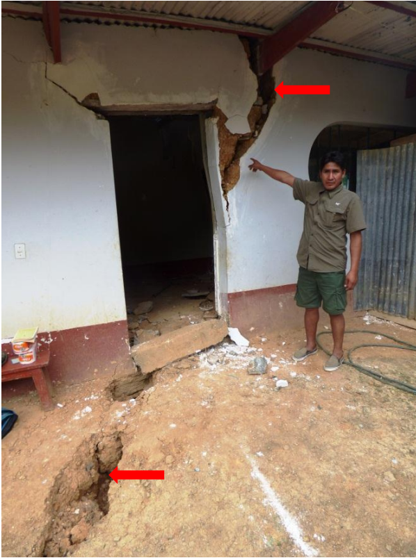
Foto 13. Grietas en el piso y en la pared de una vivienda ubicada en talud inferior de la Av. Circunvalación del Barrio Selva Alegre.
