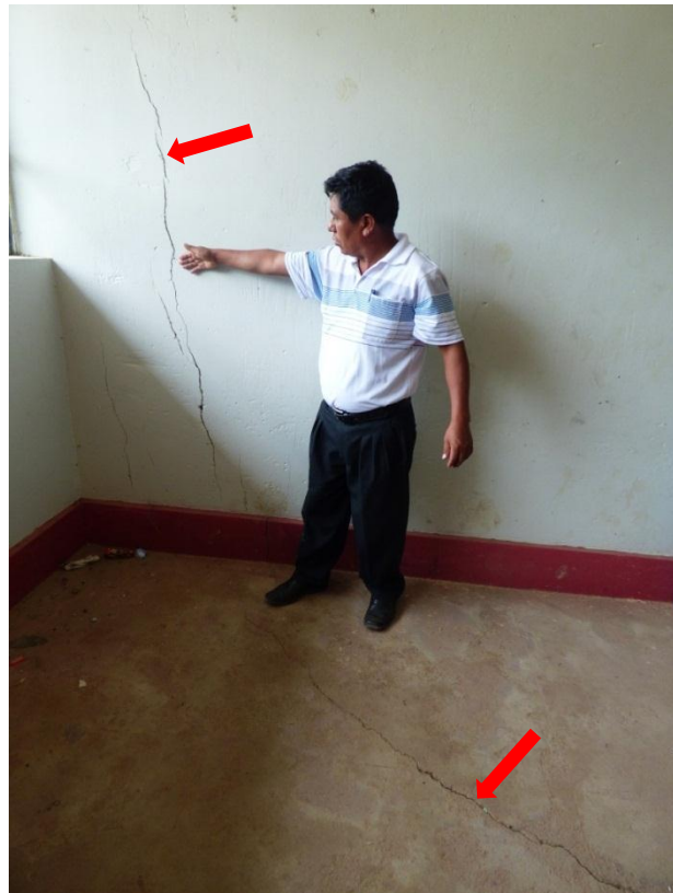
Foto 14. Fisuras en el piso y en la pared de una de las aulas de una Institución Educativa.
