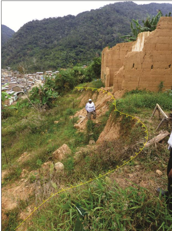
Foto 9. Salto de la escarpa del deslizamiento ubicado en el talud superior de la Av. Circunvalación.
