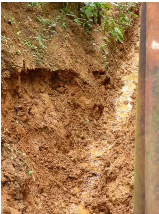
Foto 10. Suelo saturado de agua.
