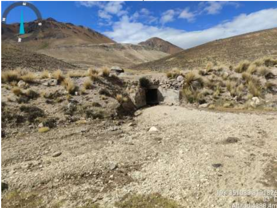
Foto 8: Vista de alcantarilla existente en muy mal estado de conservación km 12+710
