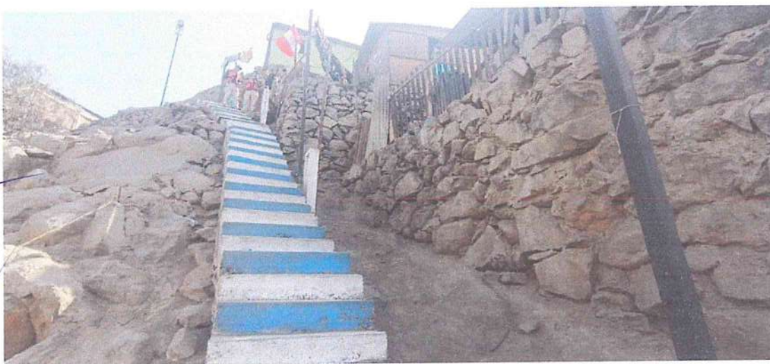
Escaleras sin barandas en la AF Virgen del Carmen
