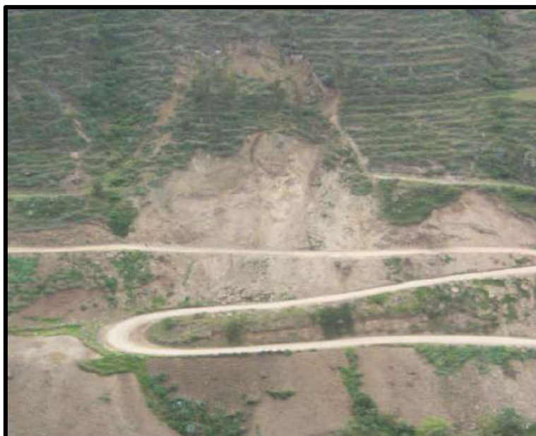
Ilustración 19. Deslizamiento traslacional en el sector de Bambamarca.
