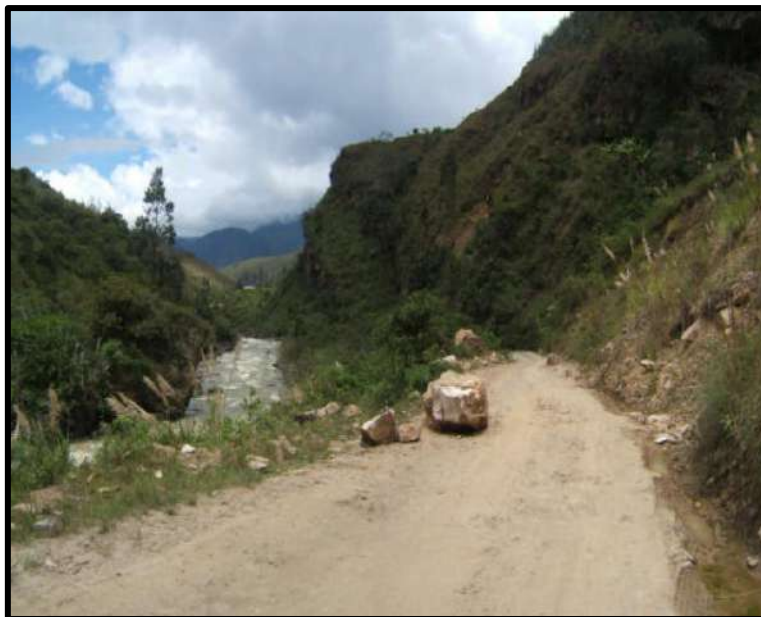
Ilustración 17. Presencia de caída de rocas en el tramo de la carretera Bambamarca - Paccha
