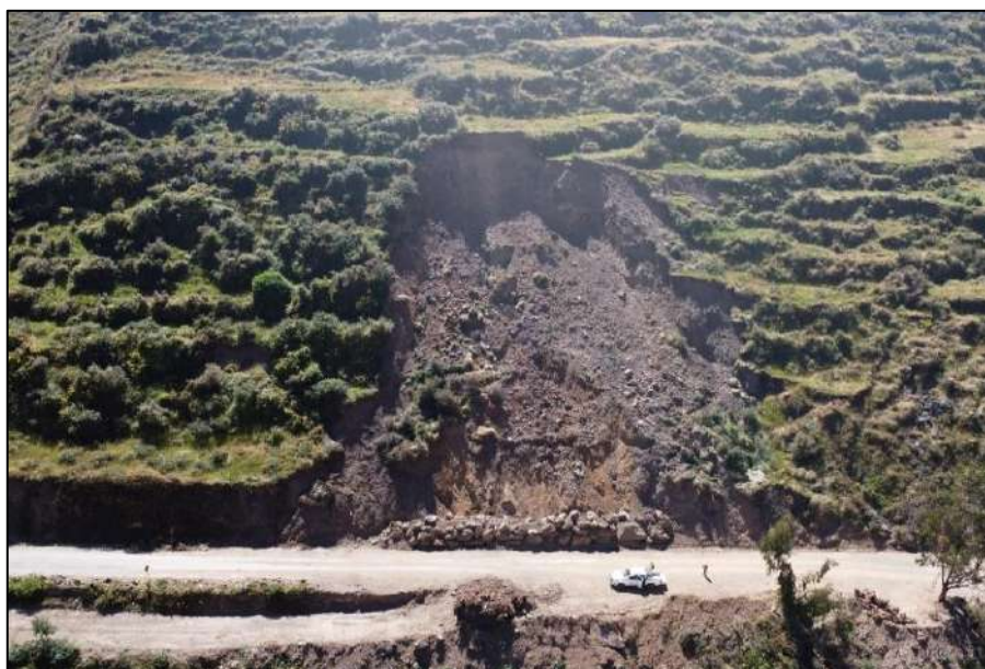
Fotografía 7. Deslizamiento en el Sector de Patacura
