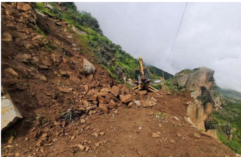
Figura 37 Fotografía de la vía cerca a la quebrada Pallcamayo donde ocurre con frecuencia deslizamientos
