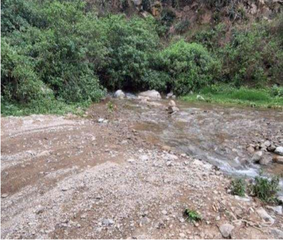
Figura 36 Fotografía de la quebrada Pallcamayo que atraviesa la trocha carrozable, vía que conecta y da acceso al centro poblado La Florida
