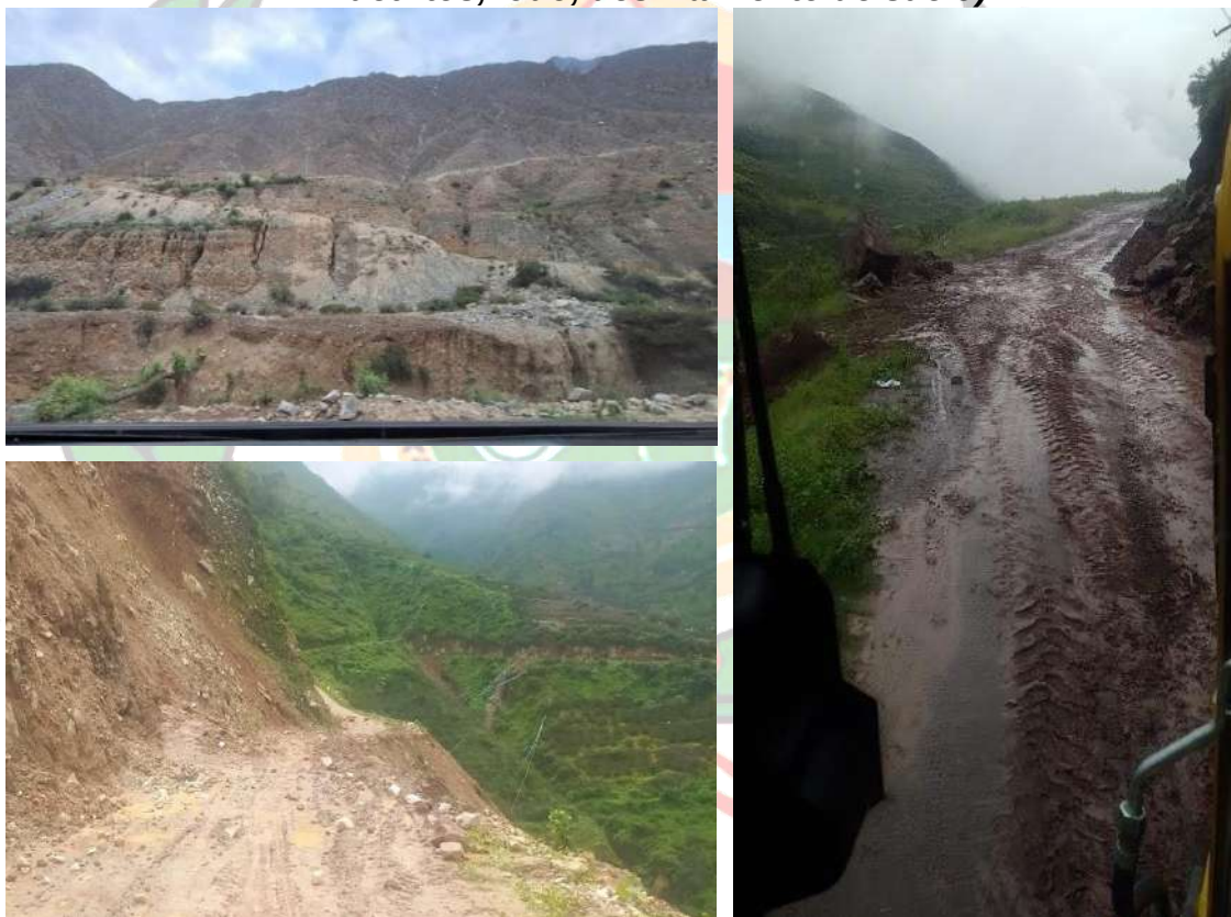
Figura 73 Carreteras y accesos expuestos a movimientos en masa (flujo de detritos, lodo, deslizamiento de suelo)
