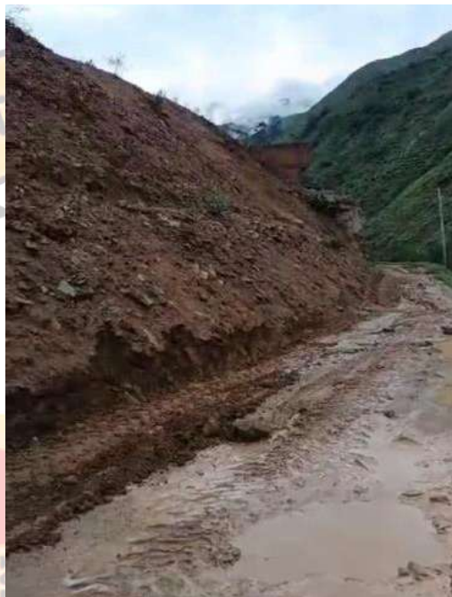
Figura 52 Desastres ocurridos en la zona crítica - Pariatacana
