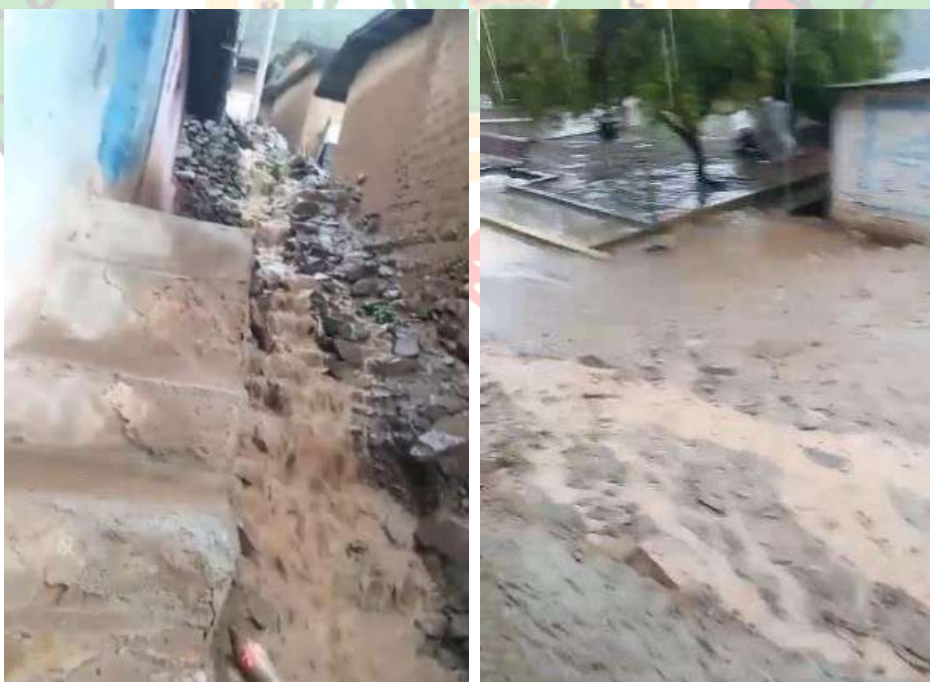
Figura 49 Afectaciones ocurridas en la zona crítica - Pueblo de Pichupampa
