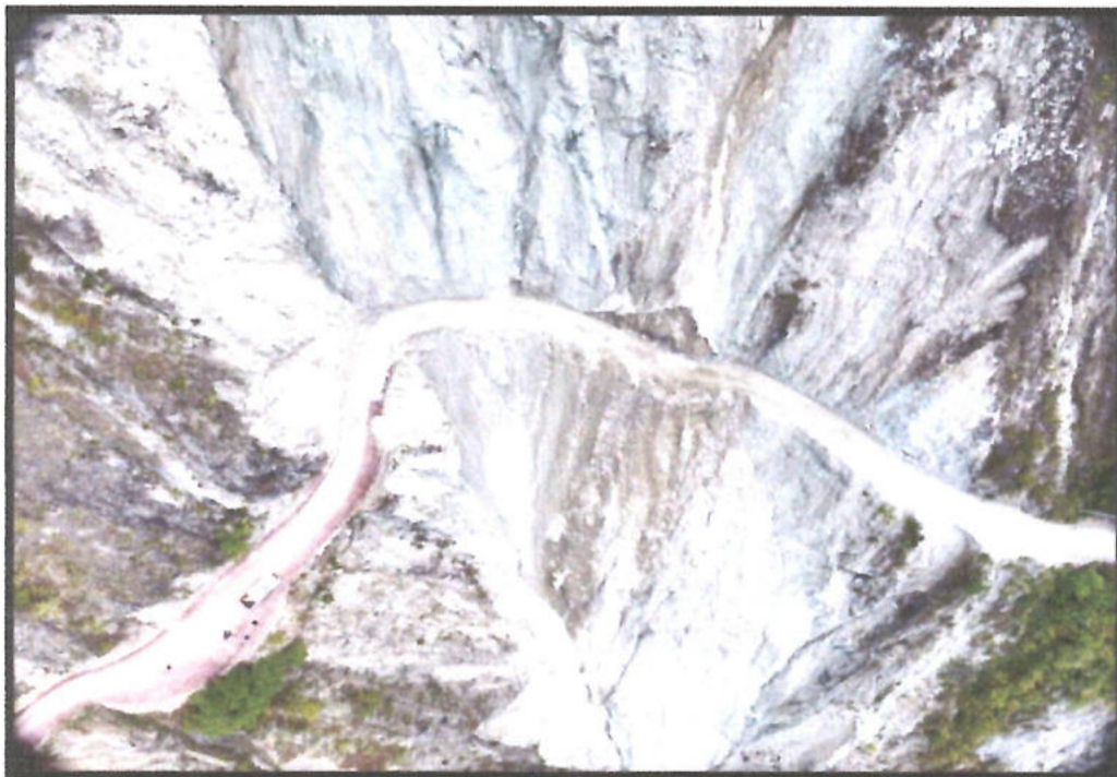
Foto N° 28: Vista aérea del estado de la carretera al sector Torrebamba
