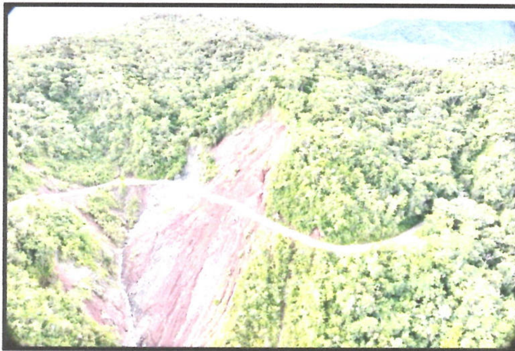
Foto N° 26: Vista aérea del estado de la carretera al sector La Suiza Alta
