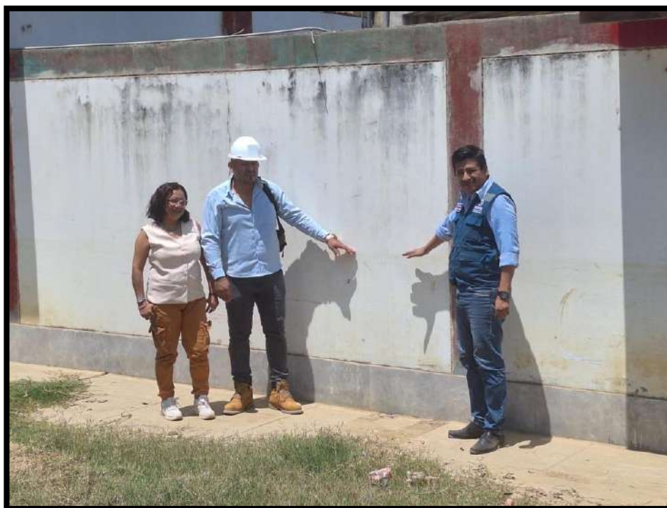
Foto 13 Levantamiento de Puntos Críticos – Cerro Blanco –Colegio Víctor Raúl – Marca de Nivel de agua producto de inundación - Marzo 2025.
