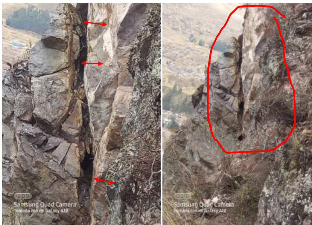
Fotografía 16. Grietas en la zona de estudio
