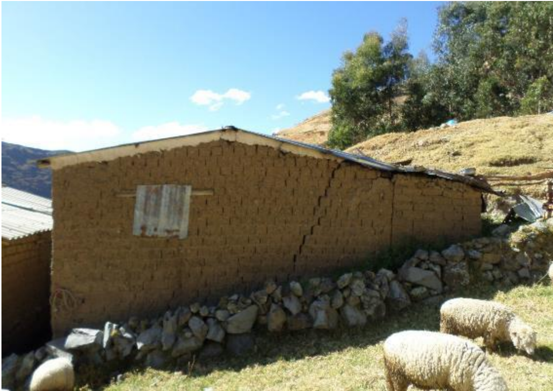
Fotografía 4: Grieta con aberturas de 7 a 10 cm. en paredes de vivienda del sector Quispar. Se ubica en las coordenadas UTM WGS84 Zona 18S, 8935566 N, 224094 E.
