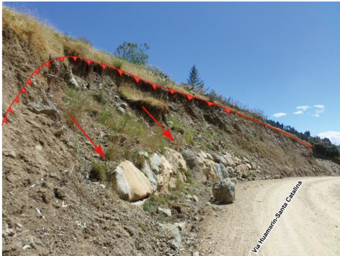
Figura 9: Vista de deslizamiento que ocurre en el talud superior de la vía Huamari-Santa Catalina con 8 m de longitud de corona.
