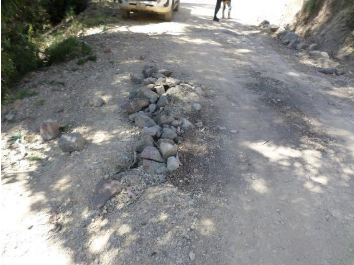
Fotografía 5: Vista del relleno de bloques que cubren el orificio que se formó producto del movimiento del terreno sobre el tramo de la carretera Huamarin-Santa Catalina.
