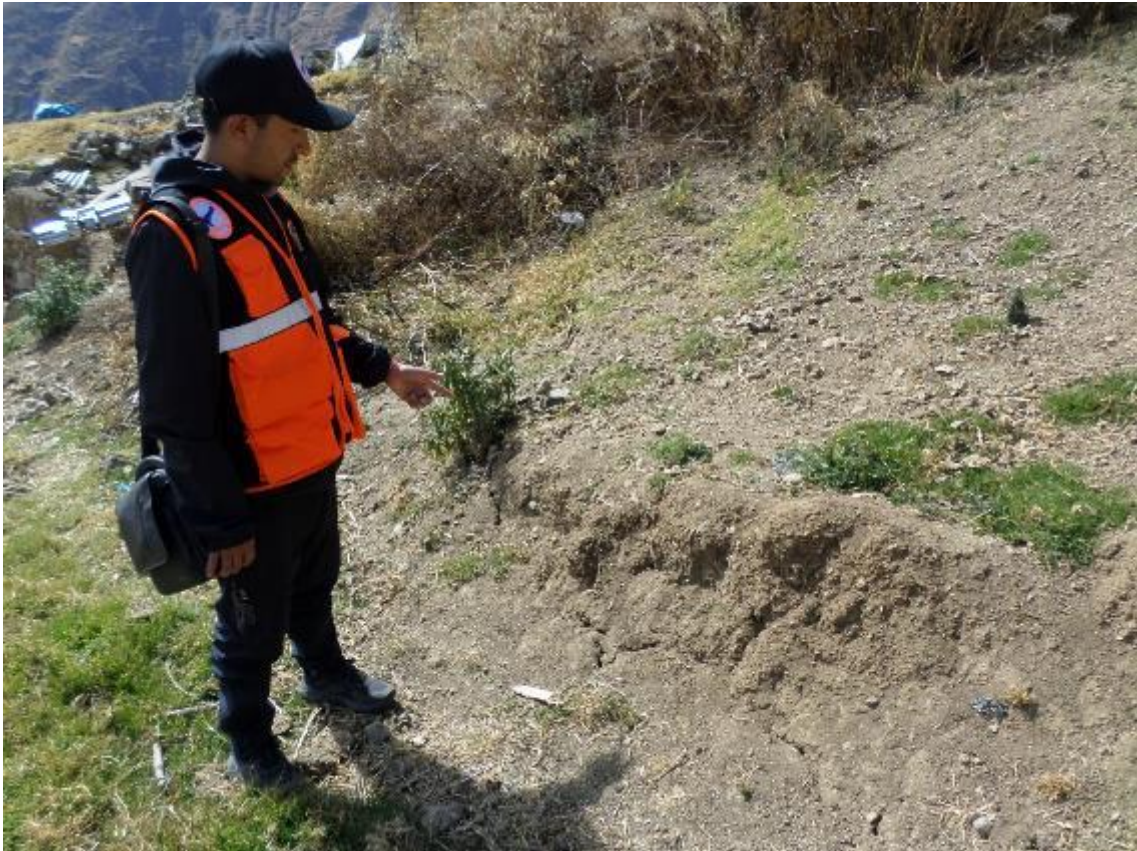
Fotografía 3: desplazamiento vertical de 35 cm sobre un terreno pastizal, esto demuestra el movimiento activo del terreno.
