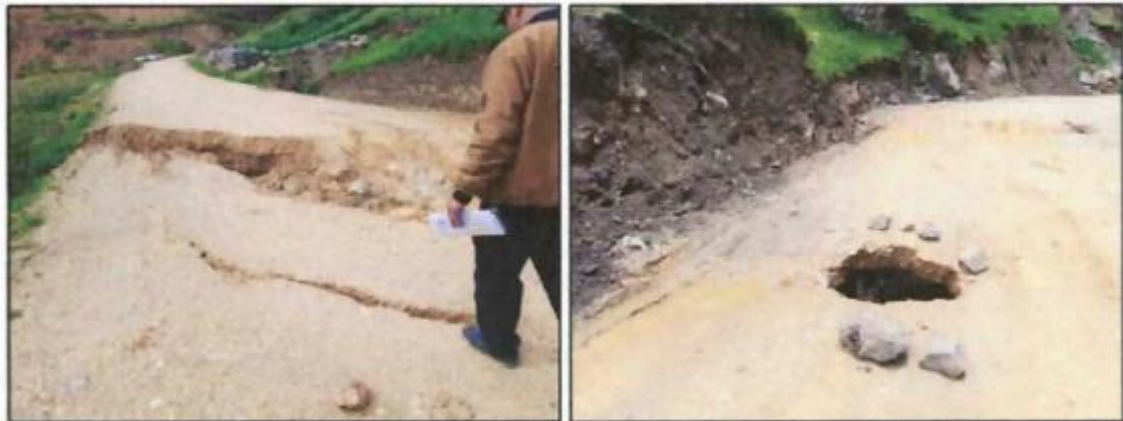
Figura 12: Vista de la carretera Huamarin-Santa Catalina antes de ser resanadas por depósitos de relleno, se evidencia el desplazamiento del terreno. Fuente: Municipalidad de Huaraz.
