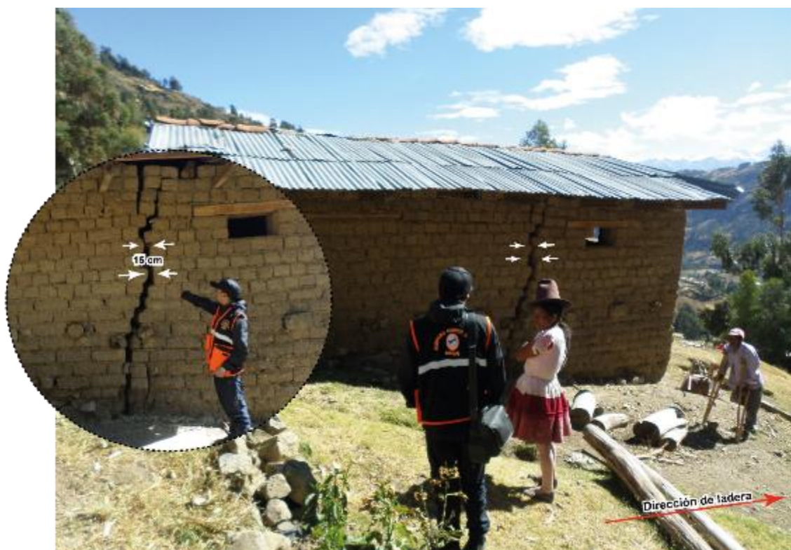
Figura 10: Agrietamientos con aberturas de 15 cm. en paredes de vivienda de adobe del sector Quispar. Se ubica en las coordenadas UTM WGS84 Zona 18S 8935537 N, 224095 E.
