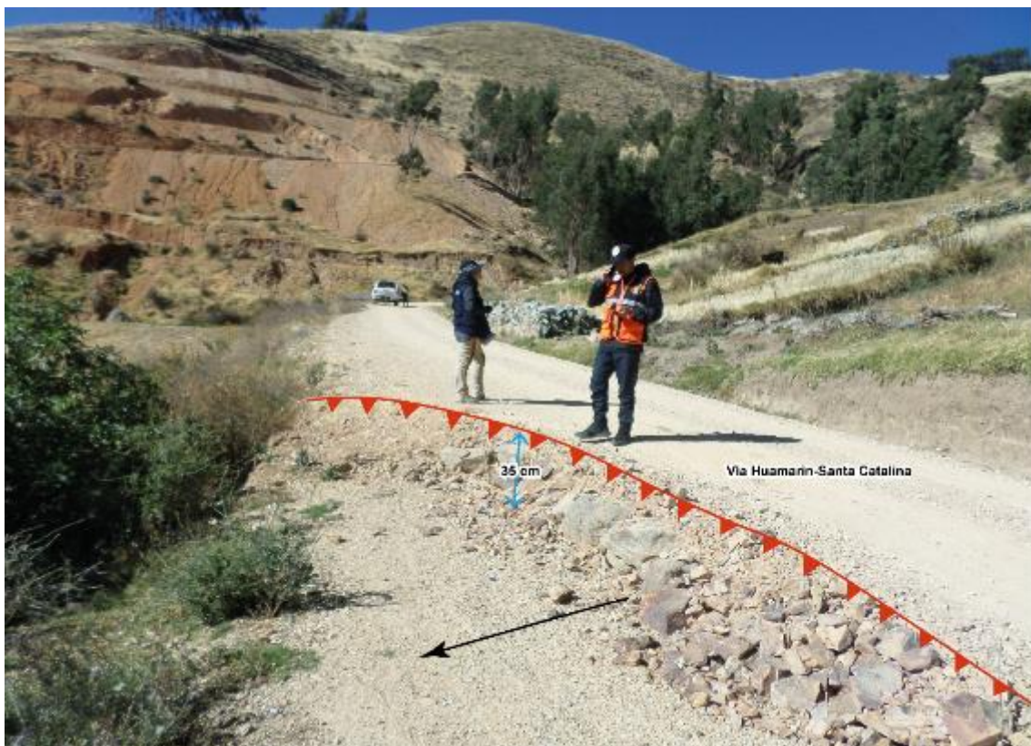
Figura 11: Vista del desplazamiento del terreno de 35 cm que afecta el tramo de la carretera Huamari-Santa Catalina, el cual se encuentra relleno con detritos para el pase de vehículos.
