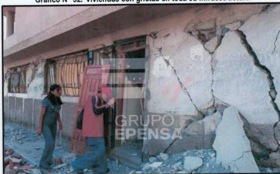
Gráfico N° 32. Viviendas con grietas en toda su infraestructura
