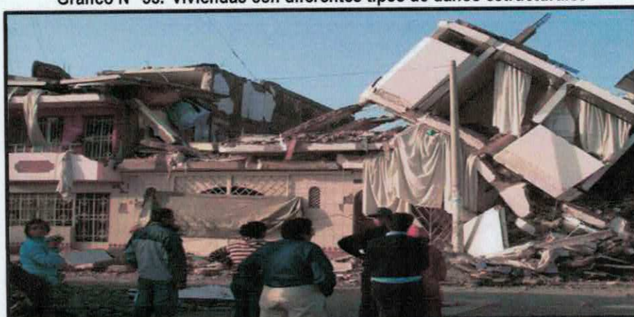
Gráfico N° 33. Viviendas con diferentes tipos de daños estructurales
