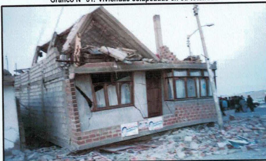
Gráfico N° 31. Viviendas colapsadas en su totalidad
