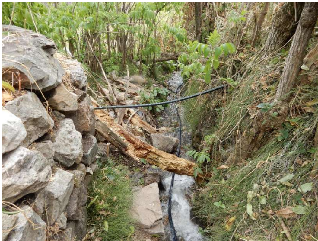
Fotografía 4. Canal de drenaje sin revestimiento que atraviesa la comunidad campesina Santa Catalina.
