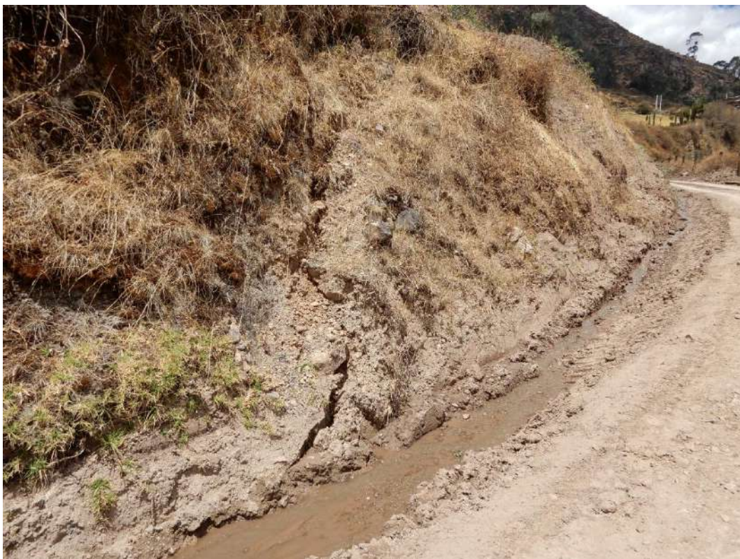
Fotografía 8. Vista de agrietamiento en el flanco derecho del deslizamiento – flujo, altura de la trocha carrozable.
