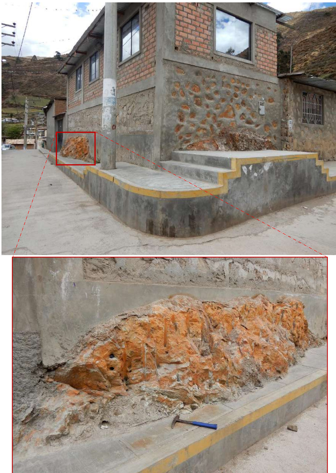
Figura 12. Bloque de una longitud de 5 m y un ancho de 0.80 m transportado por el deslizamiento reactivado.
