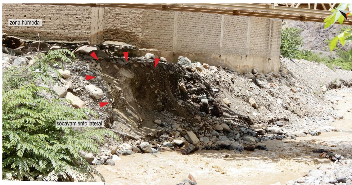
Figura 13. Socavamiento lateral provocado por un flujo reciente que discurre sobre la quebrada Cachipampa. Vista mirando al noreste.
