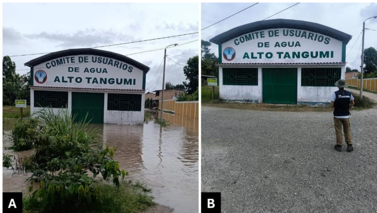
Figura 13. A. Inundación del Comité de usuarios de agua en San Juan de Tangumi. Se observa también la afectación de la I.E 00801" (Fuente: Municipalidad distrital de Calzada) B. Estado actual (2025).
