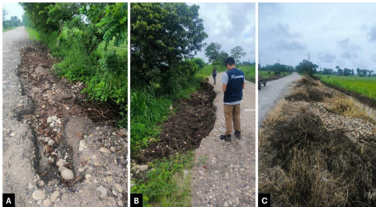
Figura 15. Erosión de las márgenes de la carretera marginal Norte 5N producto de las constantes inundaciones en los sectores.
