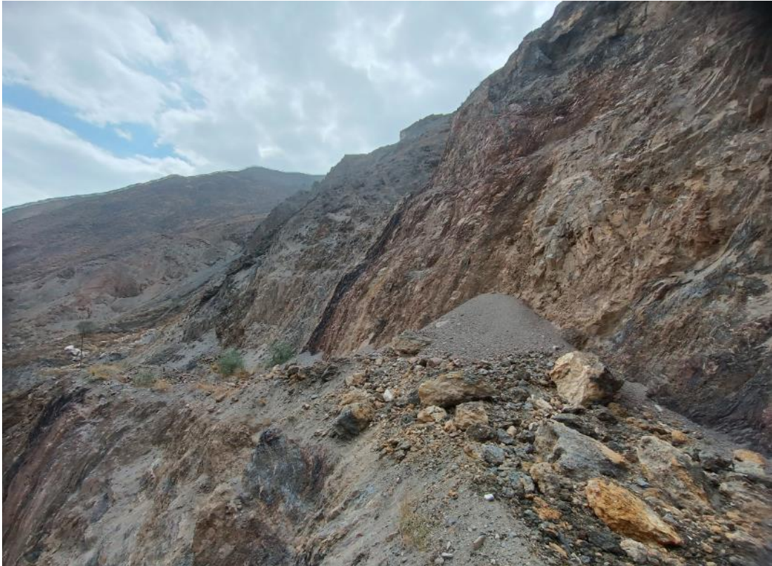
Fotografía 3. Material desprendido por derrumbes y caídas de rocas. Resaltar que durante la inspección se desprendían aún pequeños bloques rocosos, lo que resalta la inestabilidad del talud. Coordenadas UTM 8803938 N; 294578 E.
