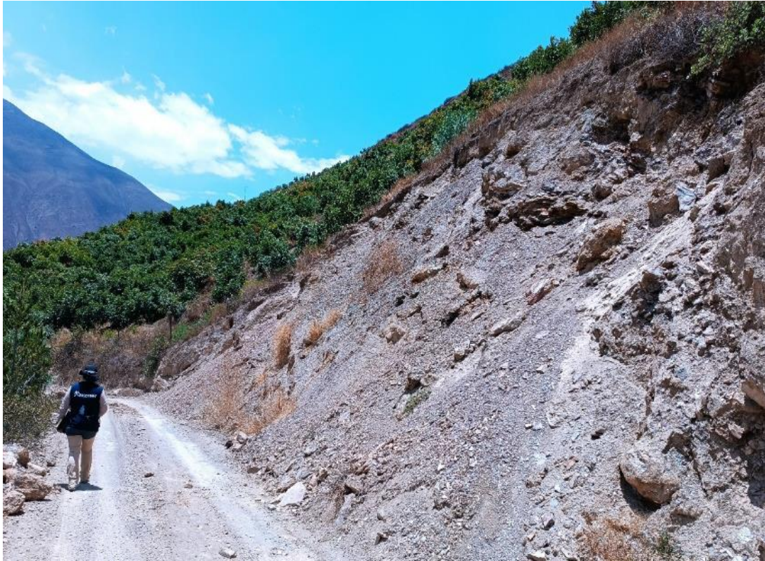
Fotografía 2. Vista en dirección sur del deslizamiento D-03. Coordenadas UTM 8804520 N, 294062 E.
