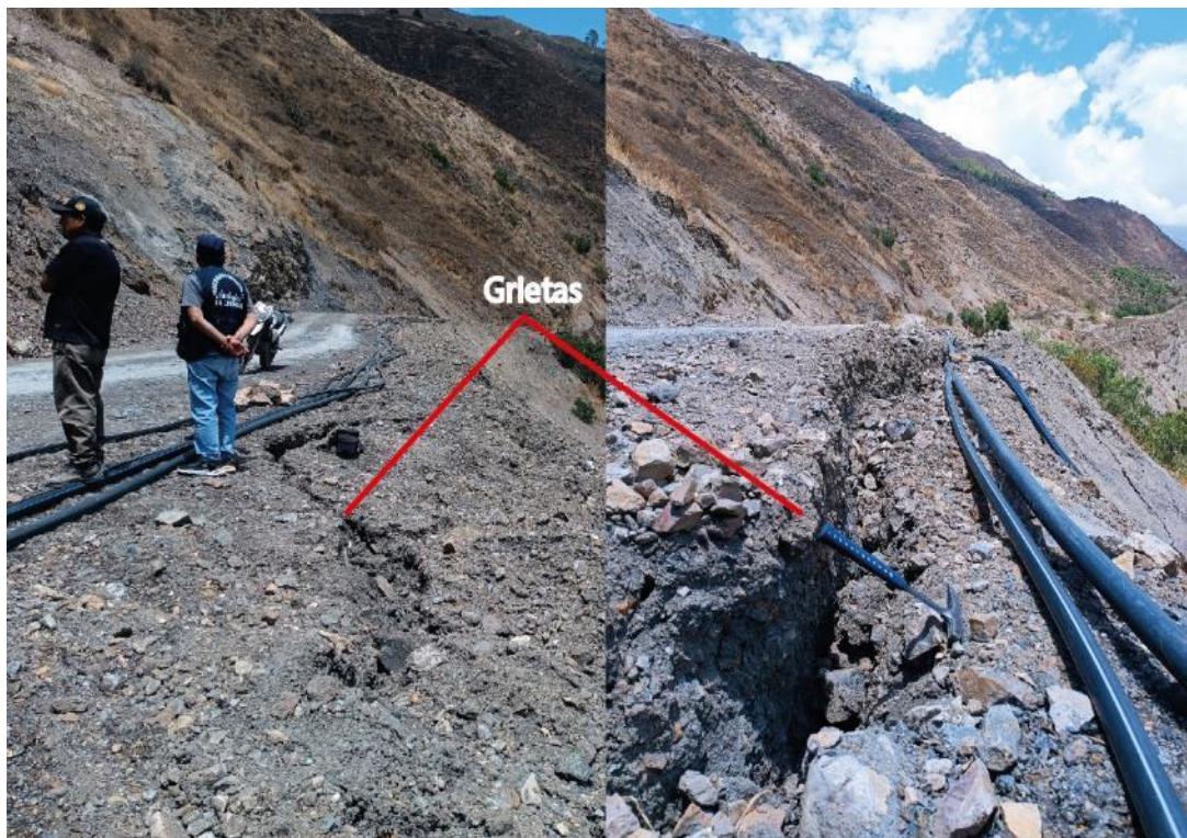
Figura 16. Grietas con saltos de hasta 30 cm. al borde de la vía La Chimba – Andajes. También se logran ver tuberías para riego de cultivos de paltas.
