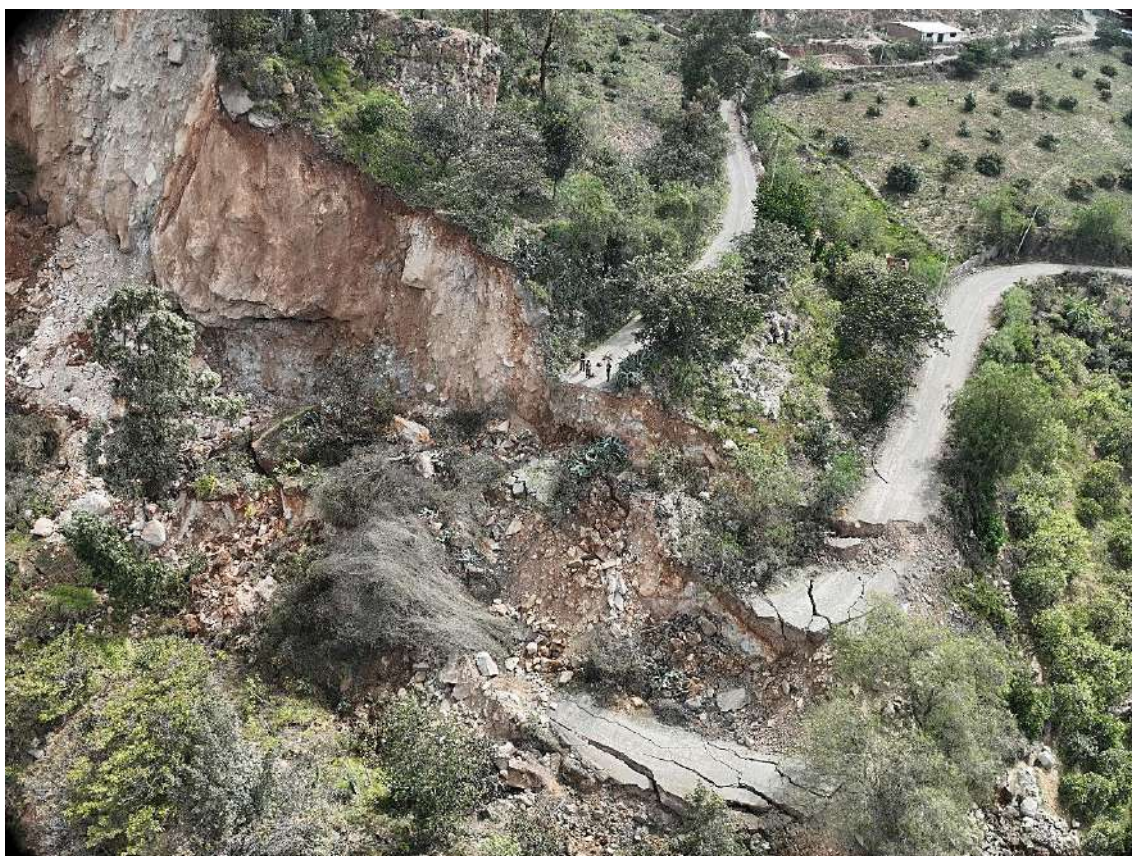
Fotografía 10. Afectación directa de la vía vecinal en un tramo de 65 m en el flanco izquierdo del deslizamiento.
