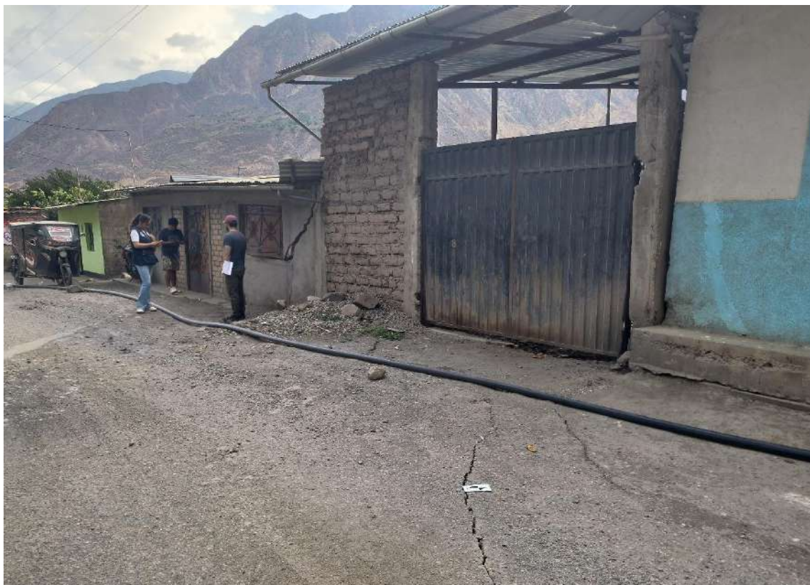
Fotografía 11. Agrietamientos en la vía nacional, así como la afectación de viviendas del sector Chanahuasi. Coordenadas UTM: 180796 / 9032455, Zona 18.
