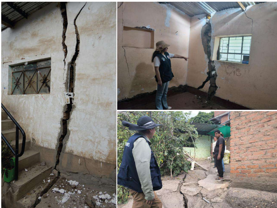
Figura 12. Daños estructurales en viviendas del sector Pampa Irca. Coordenadas UTM: 180617 / 9032798, Zona 18.
