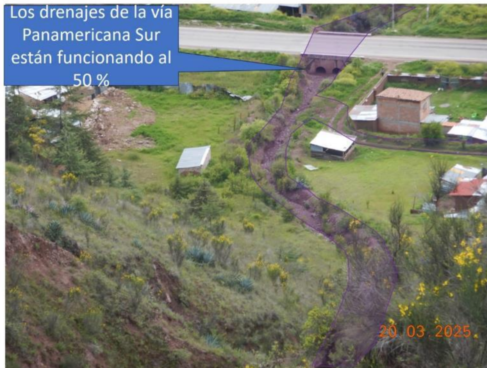
Figura 19: La cárcava 3 presenta obstrucción de los drenajes que pasan por la Panamericana Sur.
