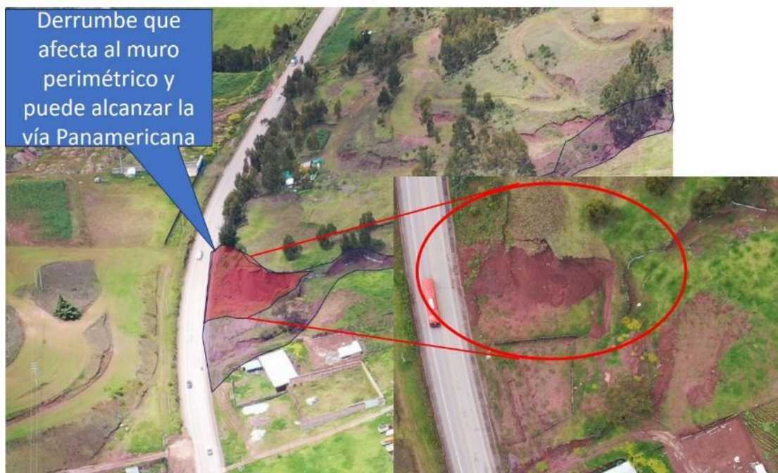
Figura 17: En la base de la cárcava 2 se puede ver un derrumbe que afecta un muro perimétrico y puede afectar la vía Panamericana Sur.
