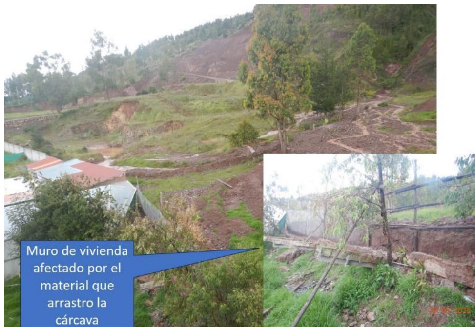
Figura 15: La cárcava 1 afectó al muro de una vivienda haciéndola caer.
