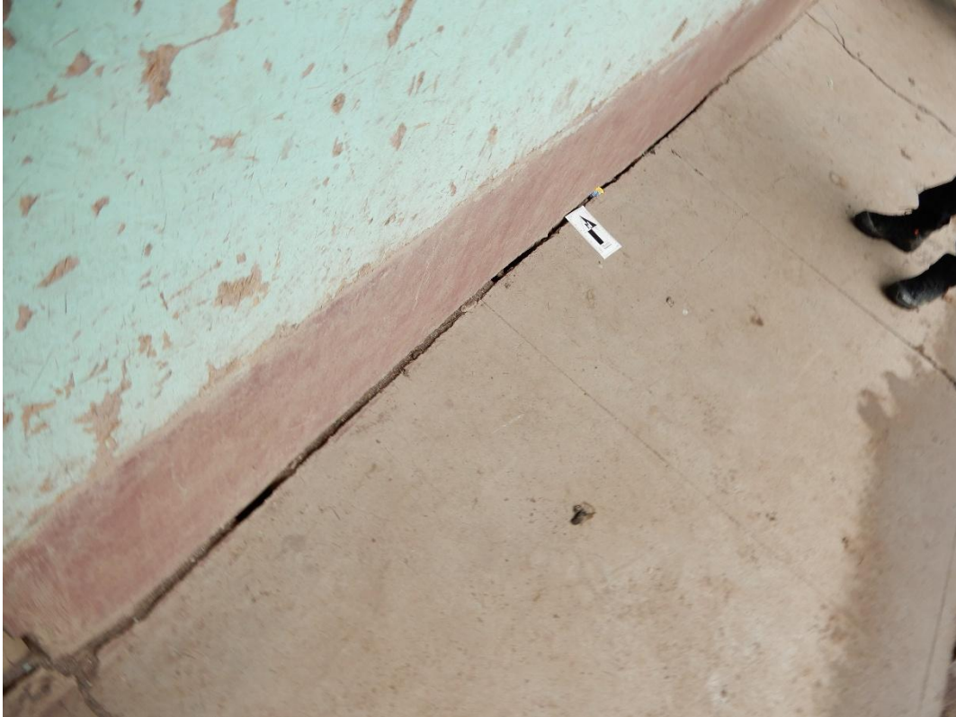
Fotografía 16. Aberturas de hasta 3 cm que separan la pared frontal con la vereda de una vivienda afectada por reptación.
