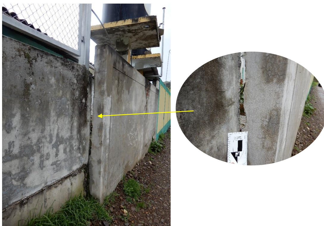
Fotografía 18. Abertura de 5 a 6 cm entre los muros de la I.E N°81661, relacionado a un ligero asentamiento de terreno.
