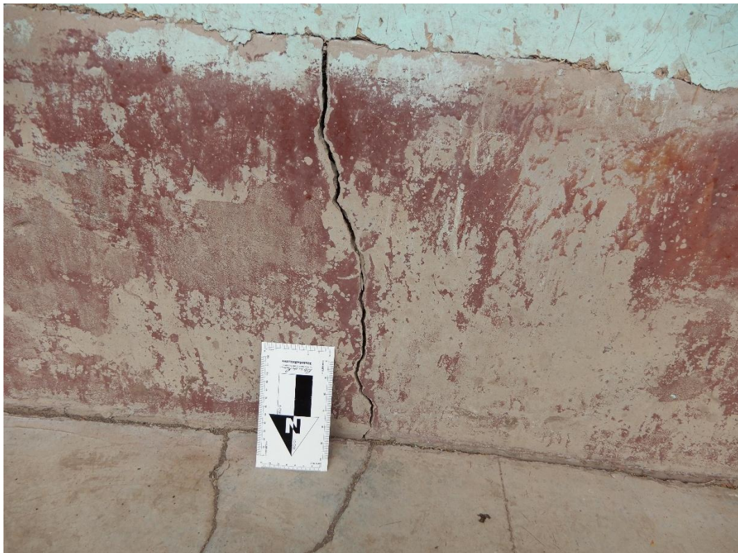
Fotografía 17. Grietas y fisuras que atraviesan transversalmente la vivienda afectada por reptación.
