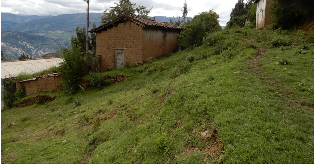
Fotografía 6: Desgarros en el terreno, en la superficie de un deslizamiento antiguo, que evidencia de reptación de suelos.
