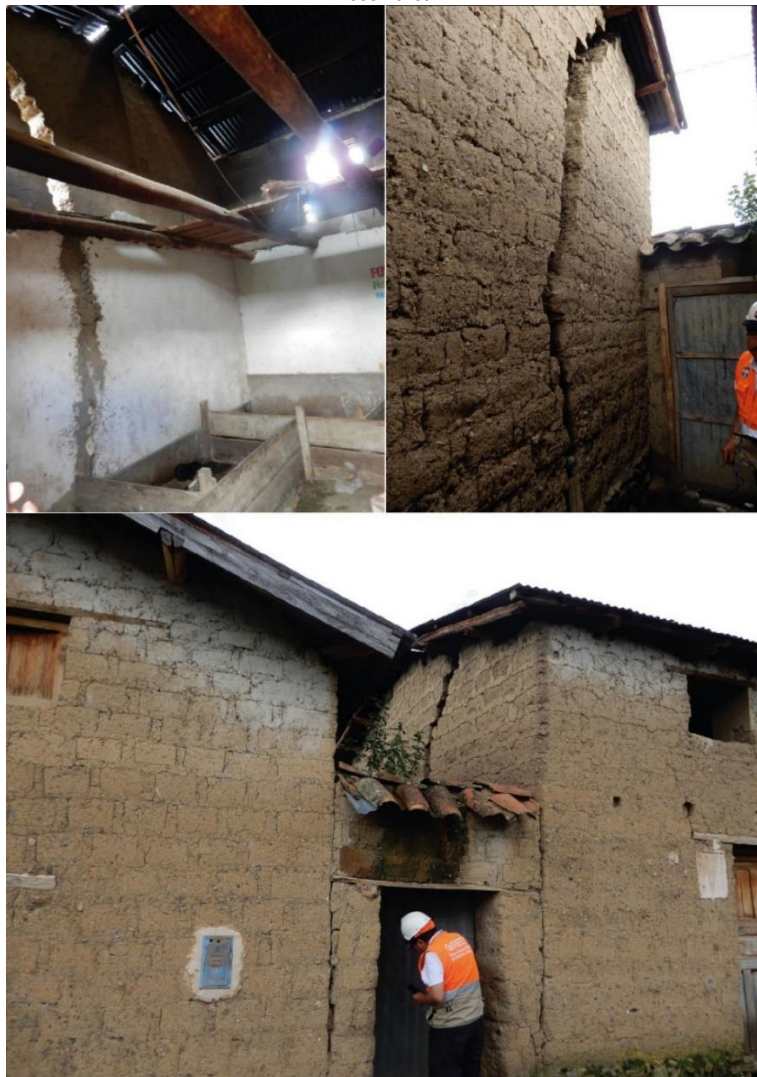
Figura 11: Agrietamientos de viviendas que demostrarían la inestabilidad del suelo por reptación en deslizamientos antiguos.
