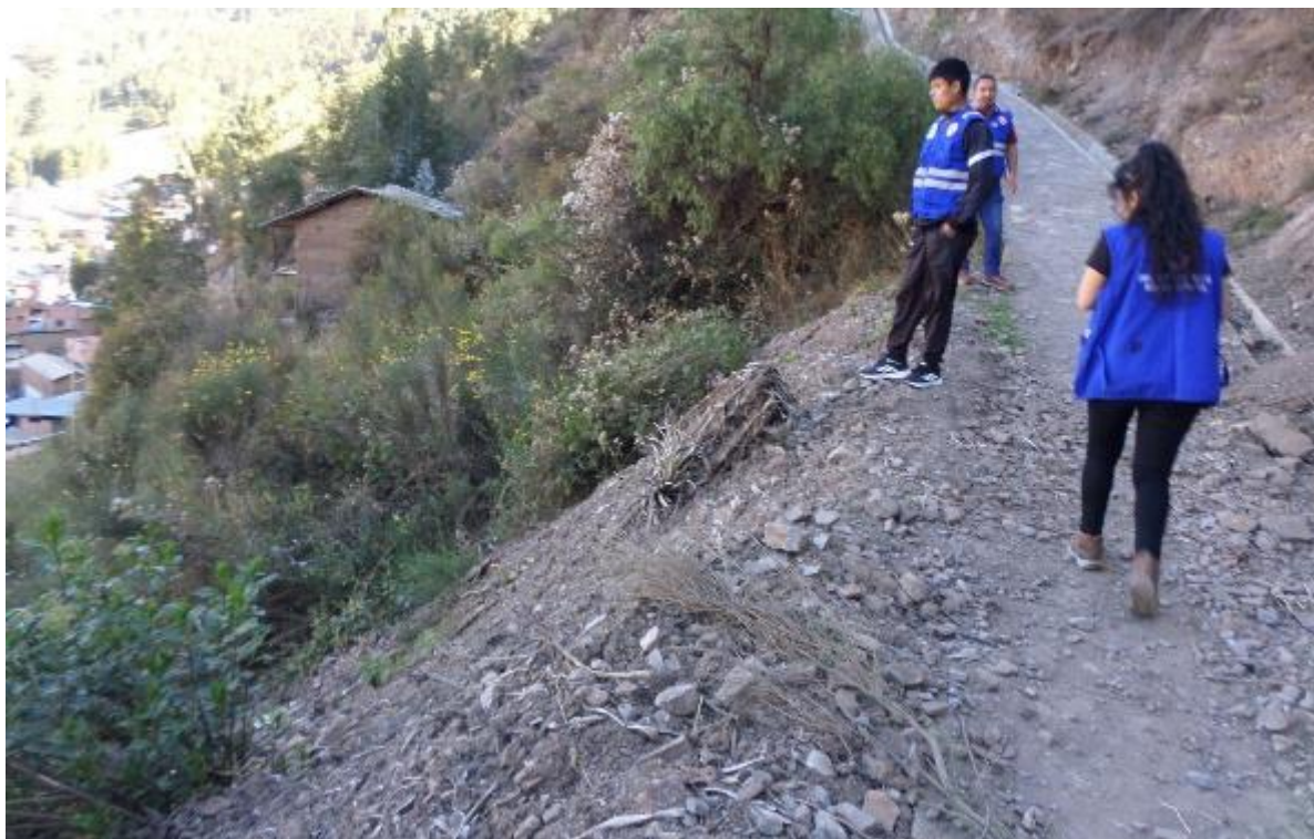
Fotografía 3. Vista del depósito coluvial conformada por fragmentos de roca (30%), gravas (40%), arena y arcilla (30%), se puede observar que corresponde a un depósito no consolidado, producto de derrumbe.
