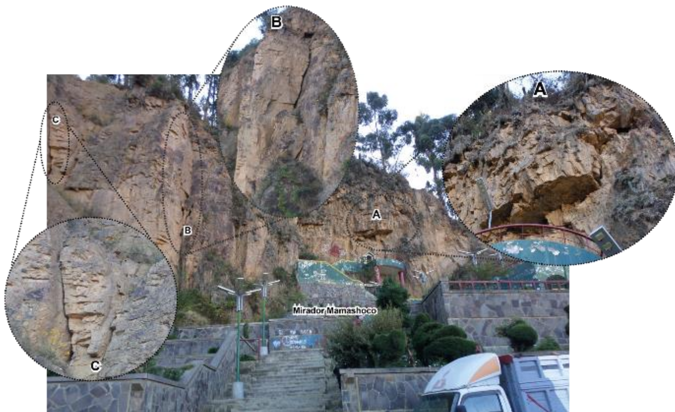
Figura 17. A. Se muestra el afloramiento rocoso que presenta aberturas de hasta 15 cm susceptible a desprenderse por completo del macizo, B. Grieta longitudinal con abertura de hasta 20 cm, el cual se prolonga hacia el ponto C, donde se evidencia abertura y desplazamiento del macizo rocoso.
