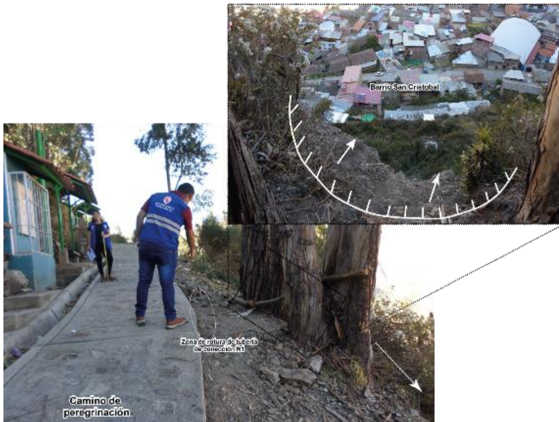
Figura 13. Vista de la zona de arranque del derrumbe provocado por la rotura de tubería que abastece el reservorio 1, el cual pasa justo apegado al camino de peregrinación.
