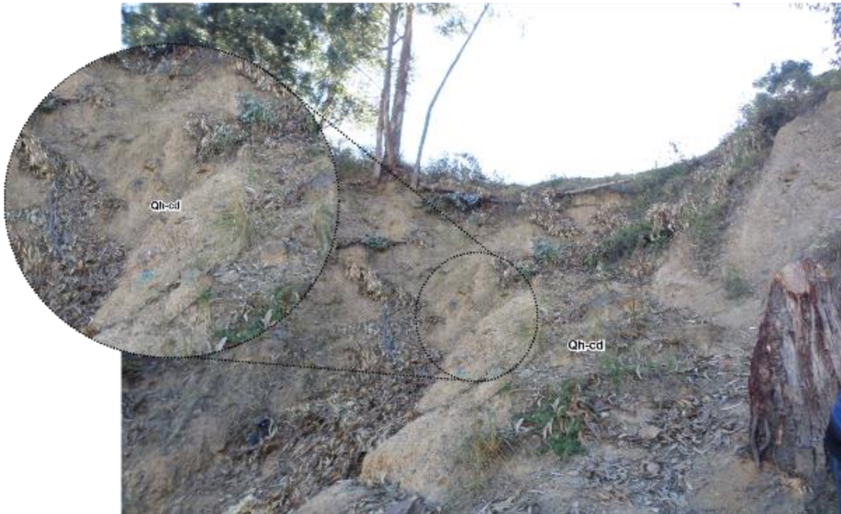
Figura 5. Depósito coluvio-deluvial compuesto por fragmentos angulosos a subangulosos de roca (10%) de tipo areniscas cuarzosas, gravas (35%) y matriz areno arcilloso (55%) y presentan una estructura caótica
