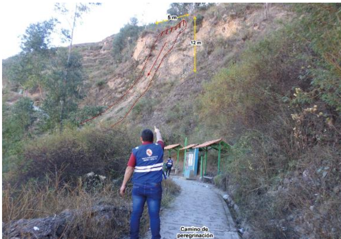
Figura 12. Vista del derrumbe provocado por la rotura de tubería con 5m de longitud de arranque y altura de arranque de 12m, en la ladera del cerro Cruz de Chullin, donde aflora la formación Oyón.
