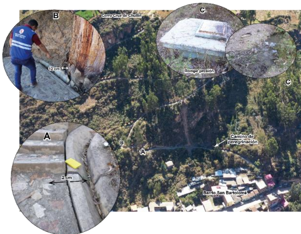
Figura 15. Vista del camino de peregrinación donde en el punto A) muestra desplazamiento de la gradería con abertura de 2 cm, B) muestra el empuje de la estructura de la gradería a causa de las raíces del árbol de eucalipto presente en la ladera, C) vista del rompe presión de la tubería que abastece los reservorios 2 y 3 donde se apreció empozamiento de agua, este exceso de agua discurre directamente a la ladera.
