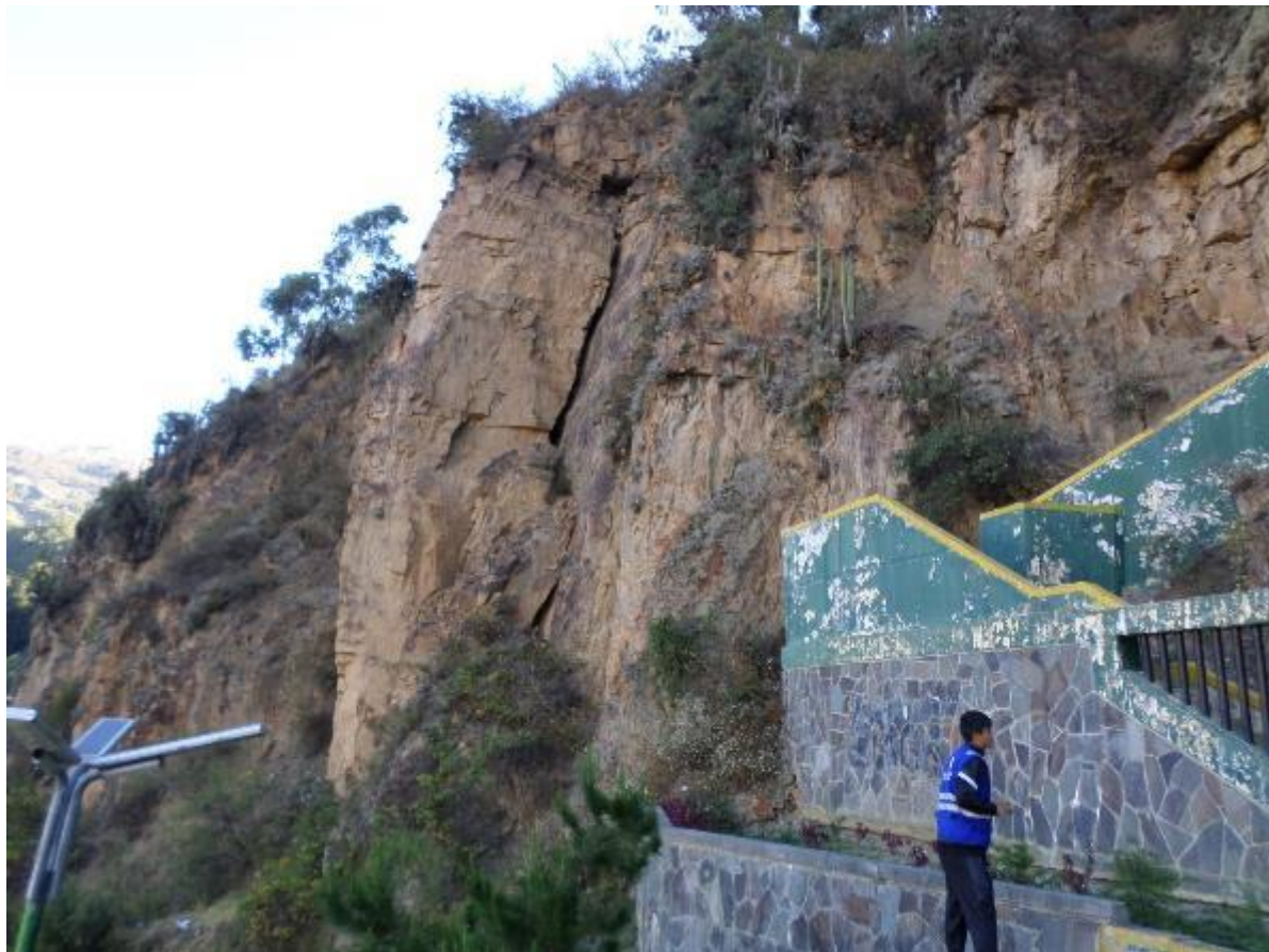
Fotografía 4. Vista del afloramiento rocoso muy fracturada a medianamente fracturada, donde se visualiza una grieta longitudinal de 10 m aproximadamente, con abertura de hasta 20 cm, esto indica que la masa rocosa ante algún tipo de movimiento ya se el sismo, corte de talud o lluvias podría ceder y afectar talud abajo.
