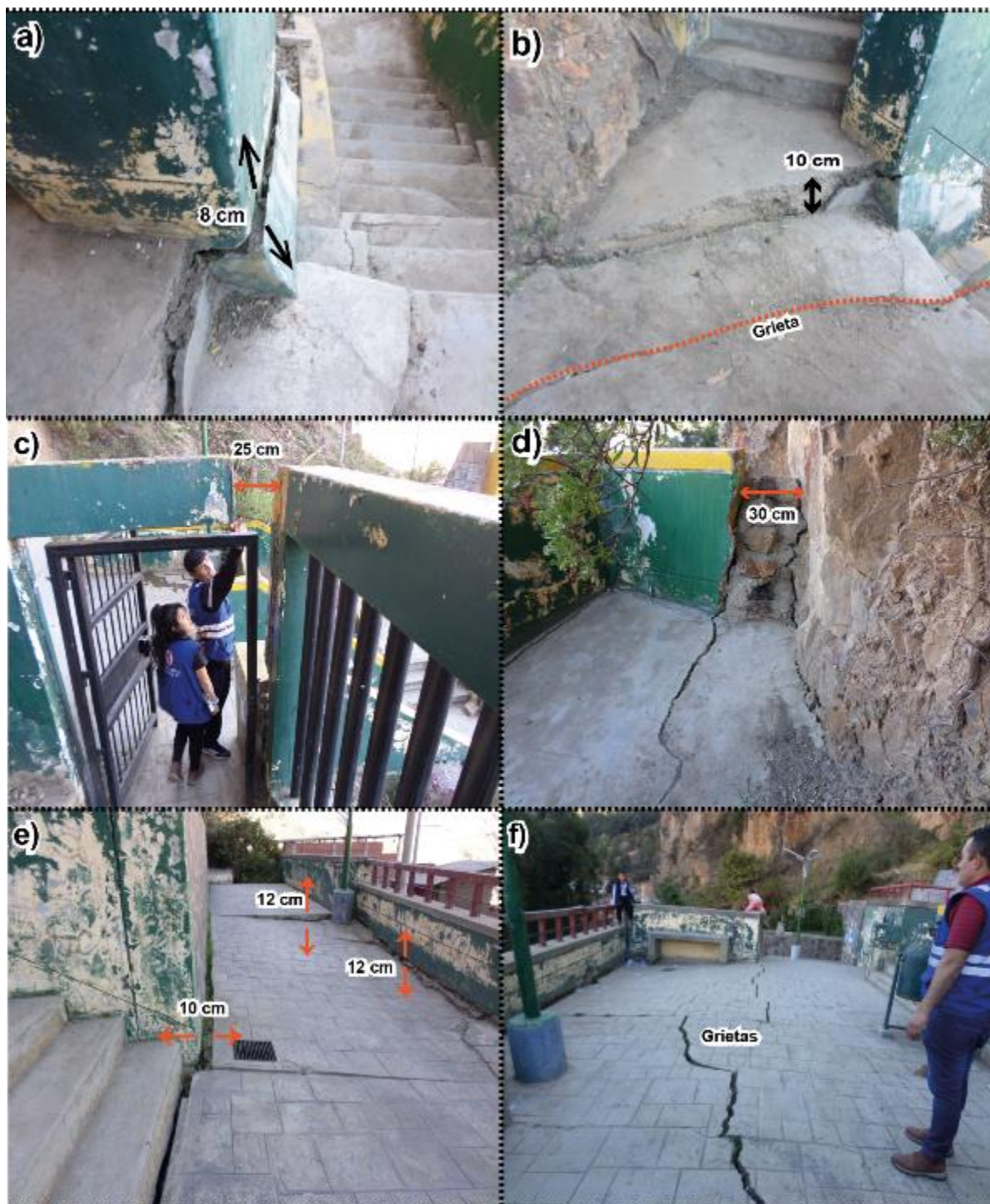
Figura 18. Vista del mirador Mamashoco, donde se muestra en los puntos a) grietas con desplazamientos de 8 cm, b) desplazamiento en las graderías de 10 cm y grietas en el piso, c) y d) desplazamientos de las paredes con abertura de 25 y 30 cm, e) aberturas en el piso de 10 cm y asentamientos de 12 cm, f) grietas en el piso a lo largo de la plataforma del mirador Mamashoco.
