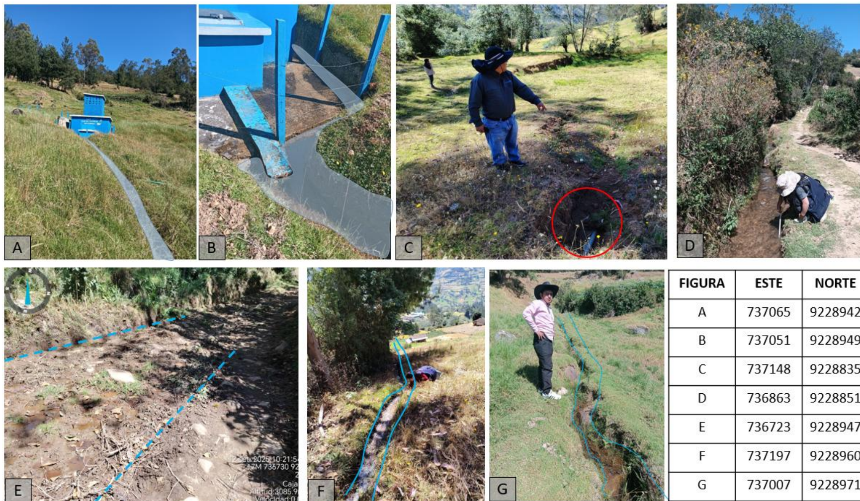
Figura.14: A. Canal sin revestimiento desde el reservorio JASS Calquis. B. Agua alrededor de reservorio JASS Calquis, producto de excedentes. C. Tubería expuesta con fuga de agua. D. Canal sin revestimiento sobre el escarpe principal, con un ancho de 1.10 m, profundidad de 0.45 m y un nivel de agua de 0.13 m. E. Agua en camino de herradura procedente del canal sin revestimiento colindante. F. Quebrada alimentada por tubería de 6'' pulgadas. G. Quebrada.
