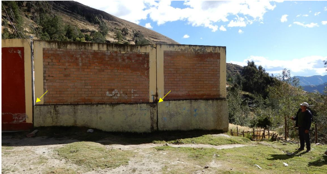
Figura 14. Ligero asentamiento (flechas amarillas indican movimiento) del cerco perimétrico de la Institución Educativa I.E N°31443 de Huacash.
