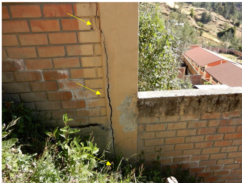
Figura 13. Grieta y fractura subvertical (indican flechas amarillas) que afecta la columna y la pared del cerco perimétrico de la institución educativa I.E N°31443 de Huacash, ubicada en el flanco derecho del deslizamiento activo.
