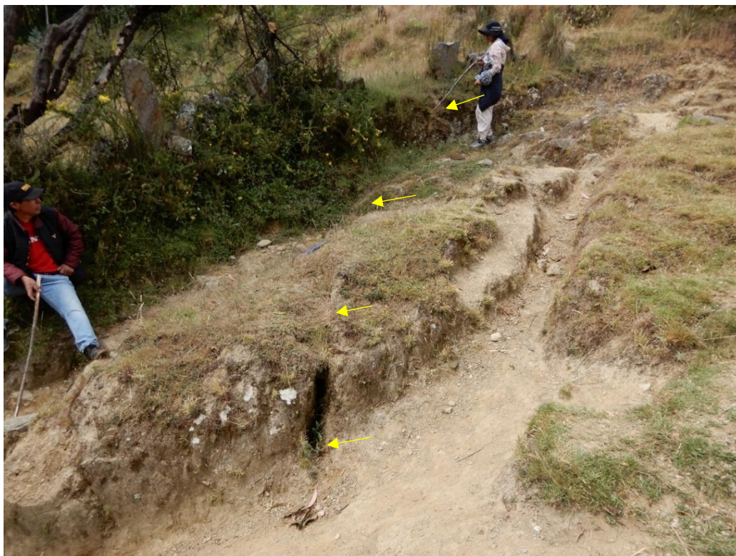
Figura 15. Grieta profunda (indica flecha de color amarillo) ubicada en el cuerpo del deslizamiento (D2). Vista mirando al sureste.
