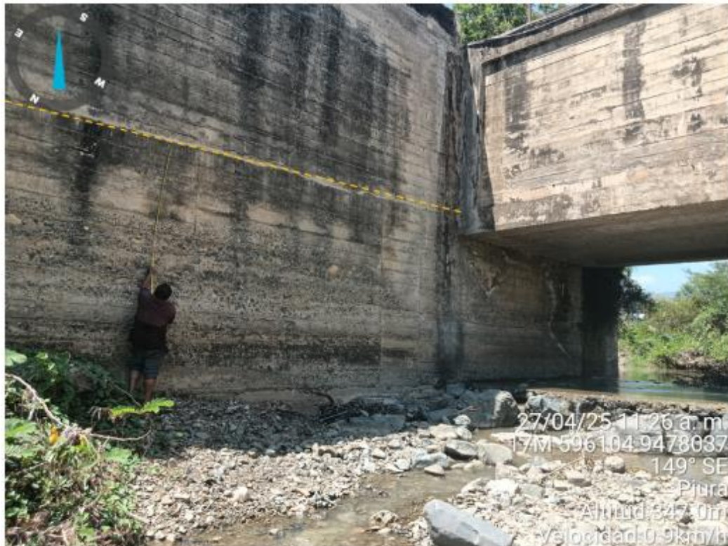
Figura 12. Altura máxima de 3.95 m donde llega la inundación de la quebrada Chipillico en sus máximas avenidas, nótese la erosión del material debido al flujo de agua. Ubicación: E:596113, N:9478030.
