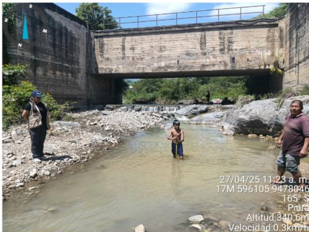
Figura 13. Altura máxima de 0.44 m de agua en quebrada Chipillico.
