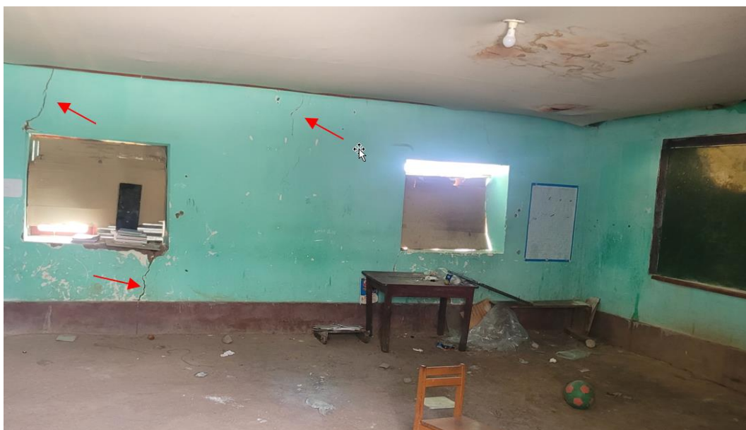
Figura 15. Se observa agrietamientos, en paredes de salón de clases.
