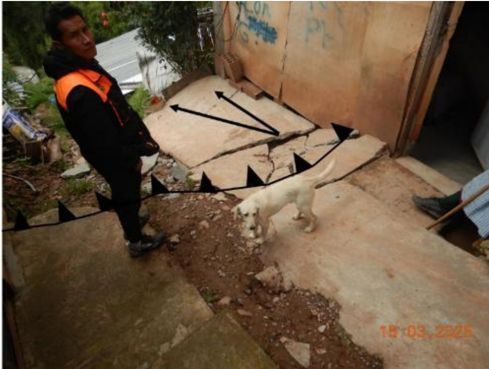
Figura 4. Frontis de la vivienda afectada por el deslizamiento, presenta grietas y hundimientos de hasta 30 cm.
