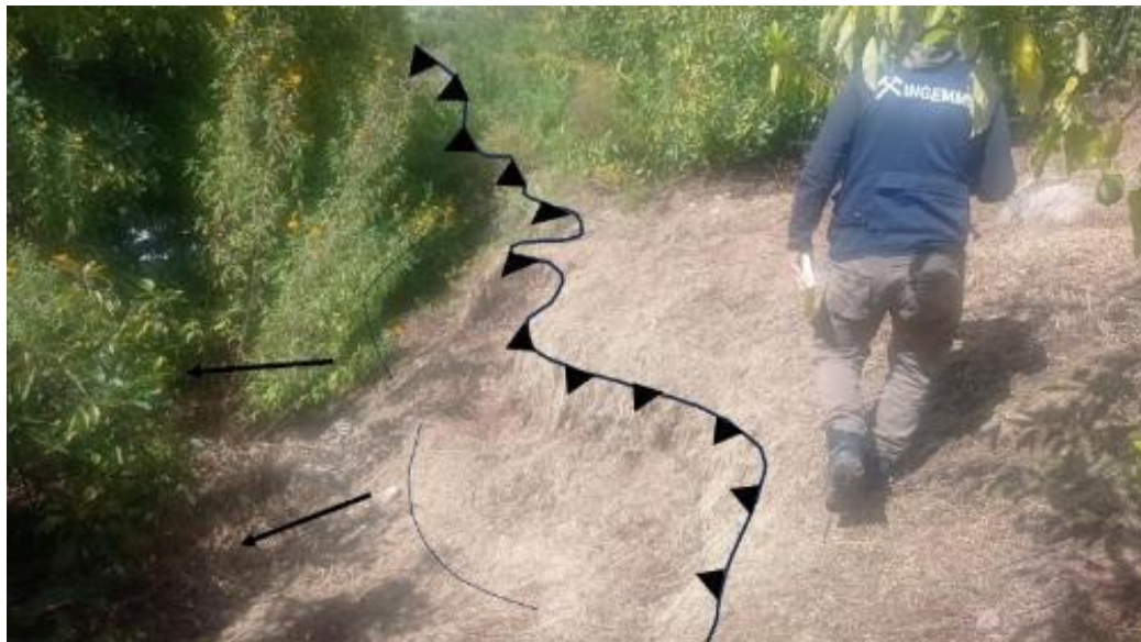
Figura 7. Escarpa de deslizamiento ubicada dentro de una chacra y que se presenta erosionada.
