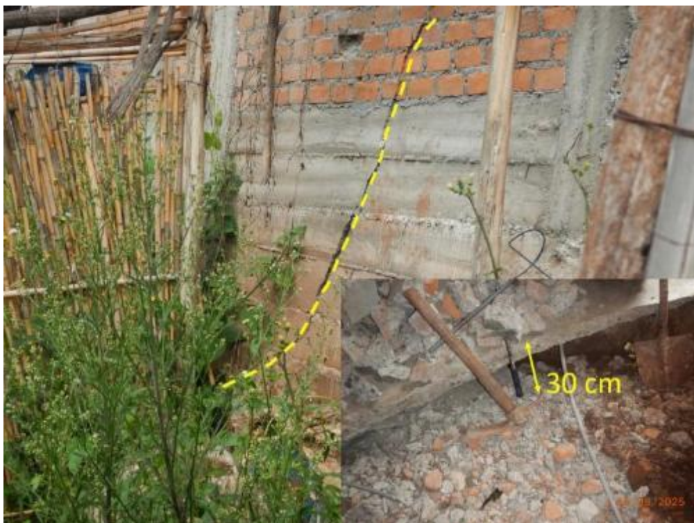
Figura 5. viviendas con presencia de grietas y hundimientos de hasta 30 cm.
