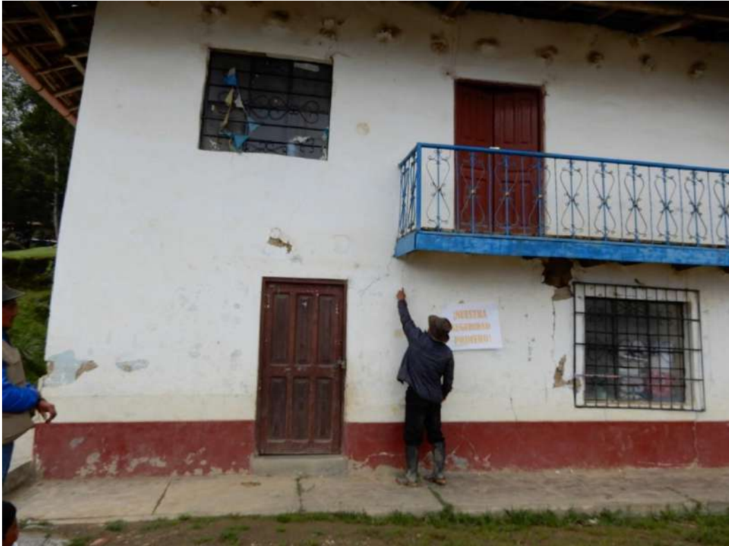
Fotografía 12. Grietas y fisuras que afectan la parte delantera de la I.E. N°80671. Estas grietas se manifiestan de manera subvertical y oblicuas que atraviesan la pared, presentan longitud de 1 a 1.5 m con aberturas milimétricas.
