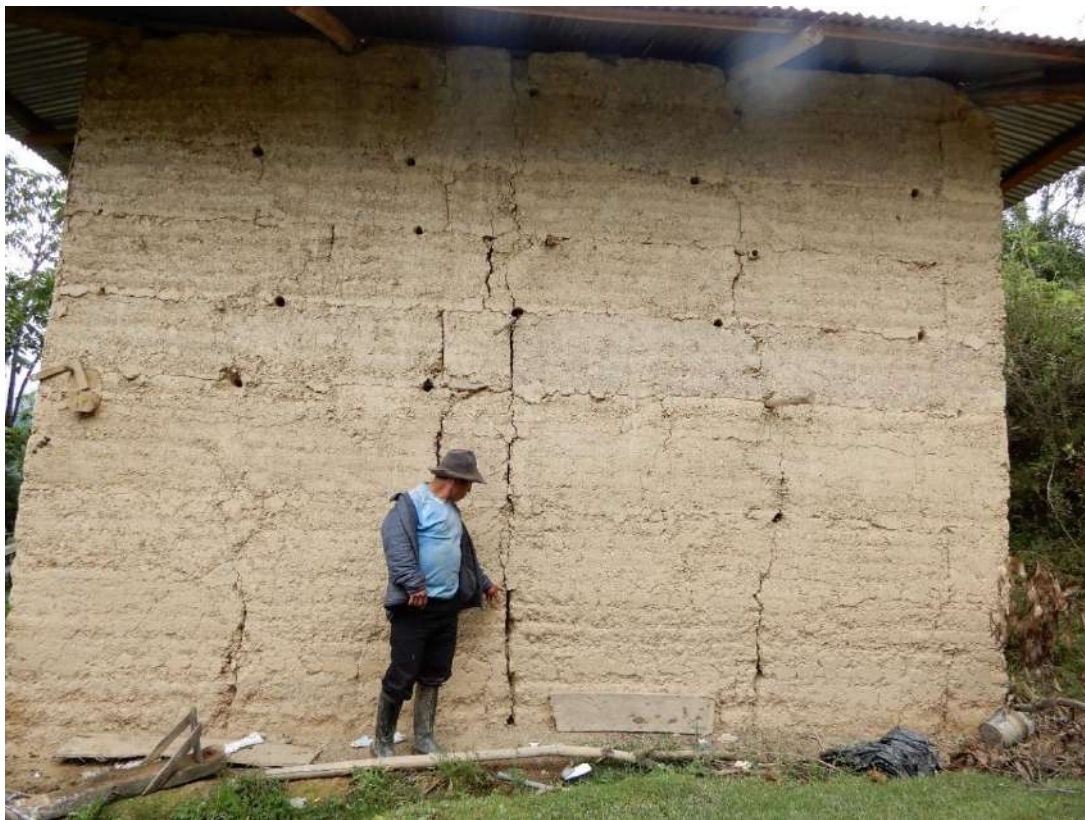
Fotografía 10. Grietas verticales que atraviesan las paredes de una vivienda ubicada en la parte proximal, cerca de lo que correspondería la zona de hundimiento del deslizamiento en desarrollo. Estas grietas evidencian movimientos diferenciales lentos pero continuos.
