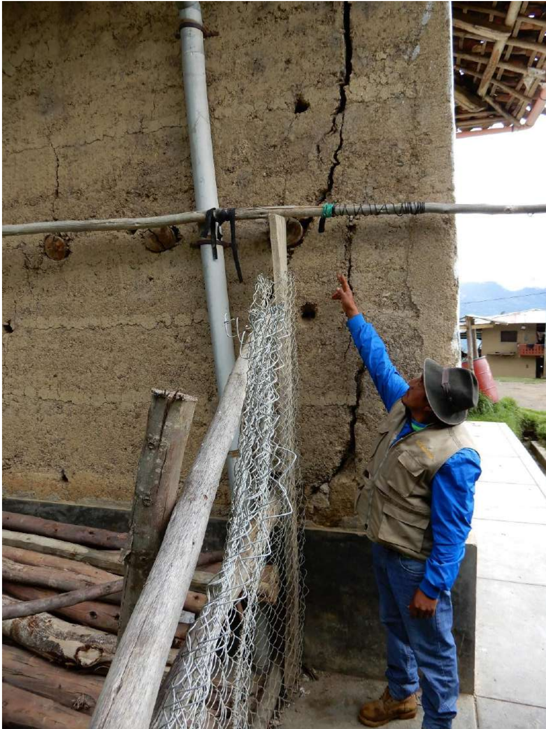
Fotografía 11. Grietas verticales y oblicuas de 2 a 8 cm de abertura que afectan la parte posterior de la pared de la I.E. N°80671. Estas grietas revelan deformaciones internas y diferenciales del terreno que configuran un deslizamiento en proceso y en estado activo.
