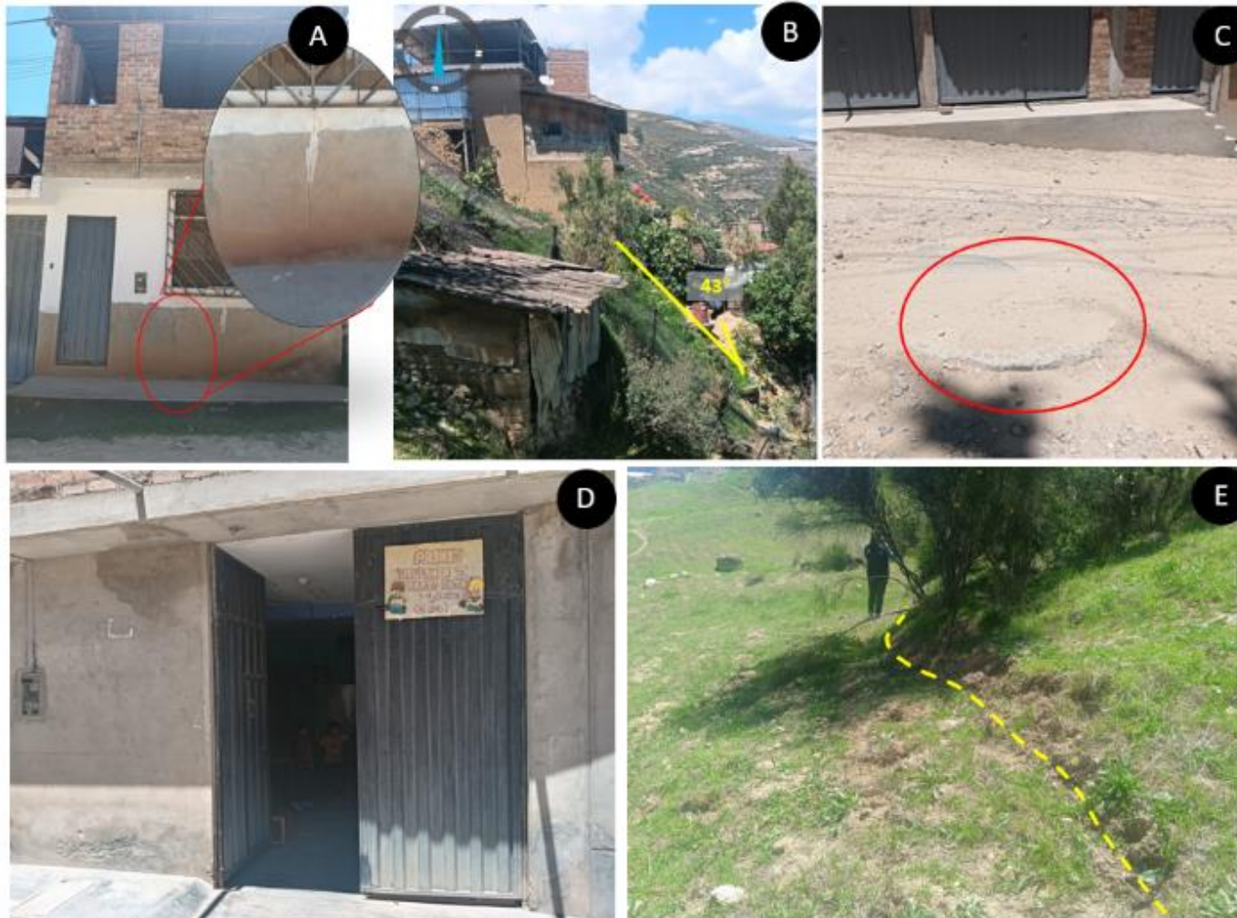
Figura 20. A. Grietas verticales en viviendas, producto de asentamientos de los terrenos. B. Viviendas ubicadas en zonas con pendientes fuertes. C. Desagüe en todas las calles. D. Pronoei Urubamba 2, instituciones ubicadas en el cuerpo del deslizamiento. E. Agrietamientos con salto de 0.25 m en la zona de escarpa antigua.
