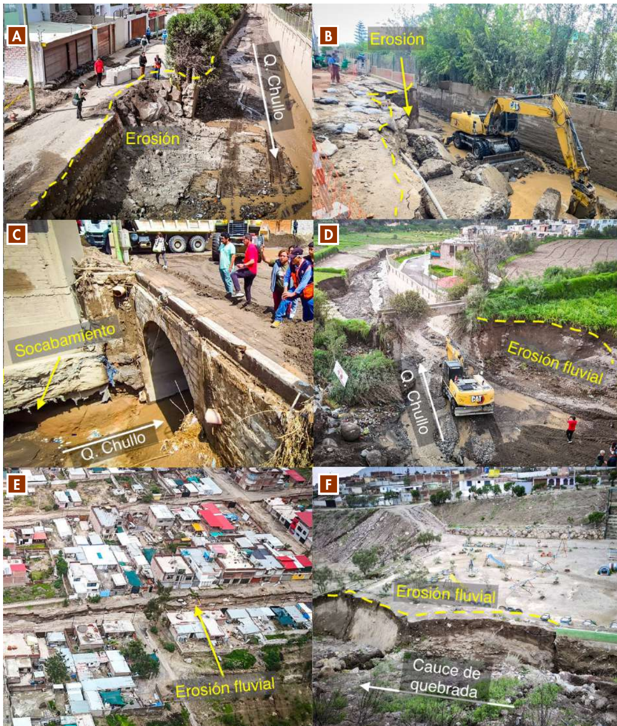
Figura 16. A y B) Quebrada Chullo en los sectores Rosario I y II, donde se registró el colapso parcial de los muros de contención. C) Arquillo I, donde se observa el socavamiento y debilitamiento de las márgenes de la quebrada. D) Arquillo III, donde ocurrió erosión fluvial de zonas agrícolas. E) Erosión fluvial en ambas márgenes de la quebrada Chullo en la urbanización Rosario I. F) Asociación Chachani I y II, donde se observan cárcavas formadas por acción erosiva de los lahares. G) Asociación Don Francisco, donde ocurrió erosión de la margen derecha de la quebrada Chullo.
