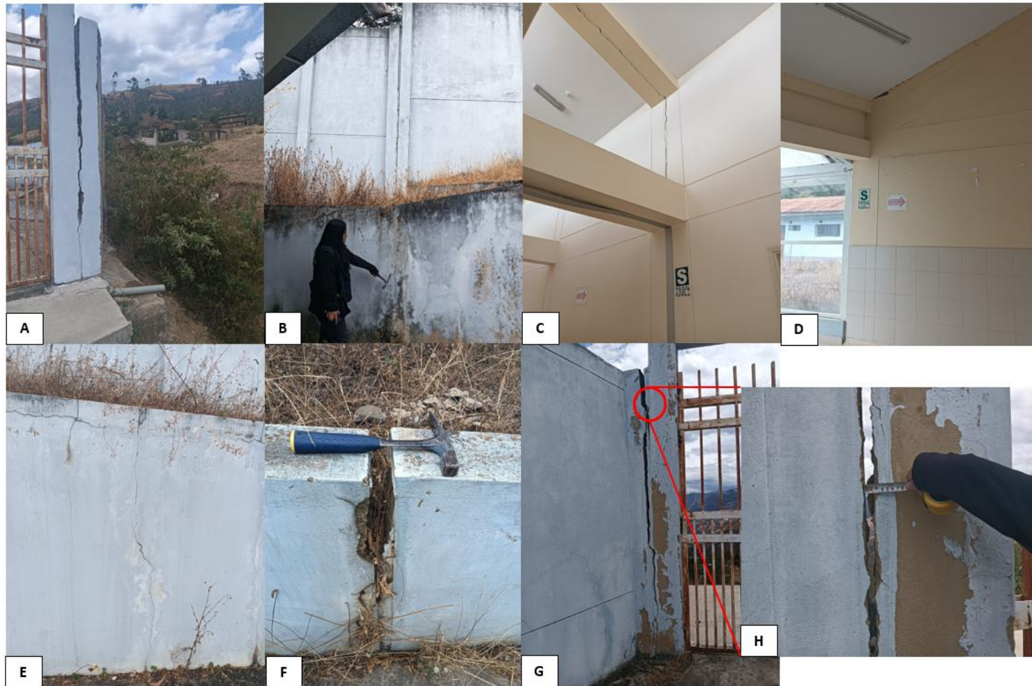
Figura 12. A. Abertura en junta de columnas externas colindantes con quebrada. B. Grietas verticales en muro interior de centro de Salud, por asentamiento de suelo de fundación. C. Grietas con abertura en pared y techo en el interior del Centro de Salud. D. Grieta en techo E. Grietas verticales en muro interior de centro de Salud. F. Abertura de 0.15 m entre juntas de muros. G. Abertura entre junta de muros colindantes a quebrada. H. Abertura de grieta de 0.027 m.
