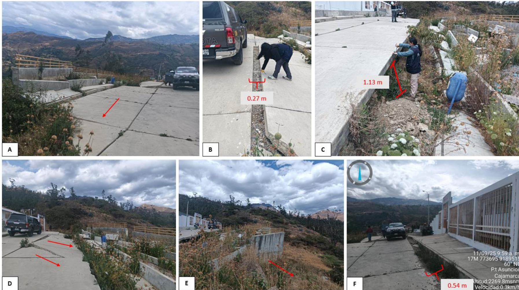
Figura 14. A. Asentamiento de terreno al frente de Centro de Salud, en dirección a la zona socavada en la margen derecha de la quebrada B. Separación de 0.27 m entre juntas del piso de la calle frente a centro de Salud. C. Socavamiento bajo el suelo de fundación de calle, con 1.13 m de suelo desplazado. D. Asentamiento de suelo de fundación y de concreto en dirección a la zona de socavada.
