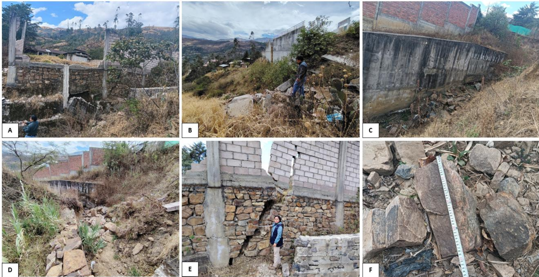
Figura 15. A. Caída de una vivienda en construcción, producto de la erosión fluvial. B. Material de muro caído obstruyendo cauce de quebrada. C. Socavamiento de base de muro que colinda con Centro de Salud. D. Bloques producto de la caída de vivienda en construcción y de rotura de canal que encausaba quebrada. E. Vivienda en construcción afectada por la erosión fluvial. F. Bloque de 0.39 m de longitud en cauce de quebrada.
