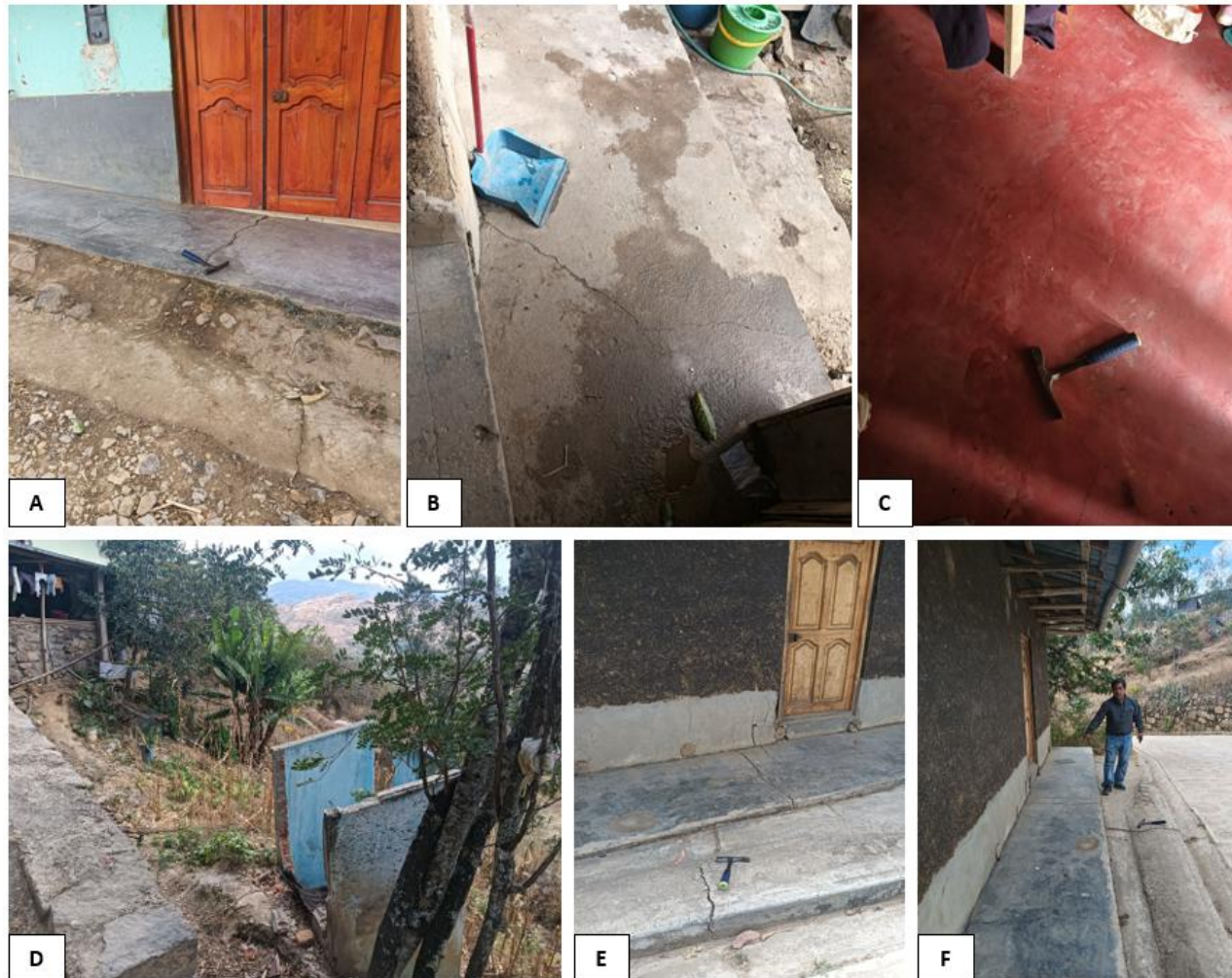
Figura 16. A. Grieta en vereda de vivienda afectada. Coordenadas: E:773633 /N:9189418 B. Grieta en piso de vereda interna de vivienda afectada. Coordenadas: E:771414 /N:9191691 C. Grieta en suelo de habitación de vivienda afectada. D. Estructura caída tras las fuertes lluvias y la pendiente, colindante a quebrada. Coordenadas: E:773670 /N:9189387 E. Grieta en vereda de vivienda afectada. Coordenadas: E:773673 /N:9189385 F. Grieta en vereda de vivienda afectada. Coordenadas: E:773671 /N:9189389
