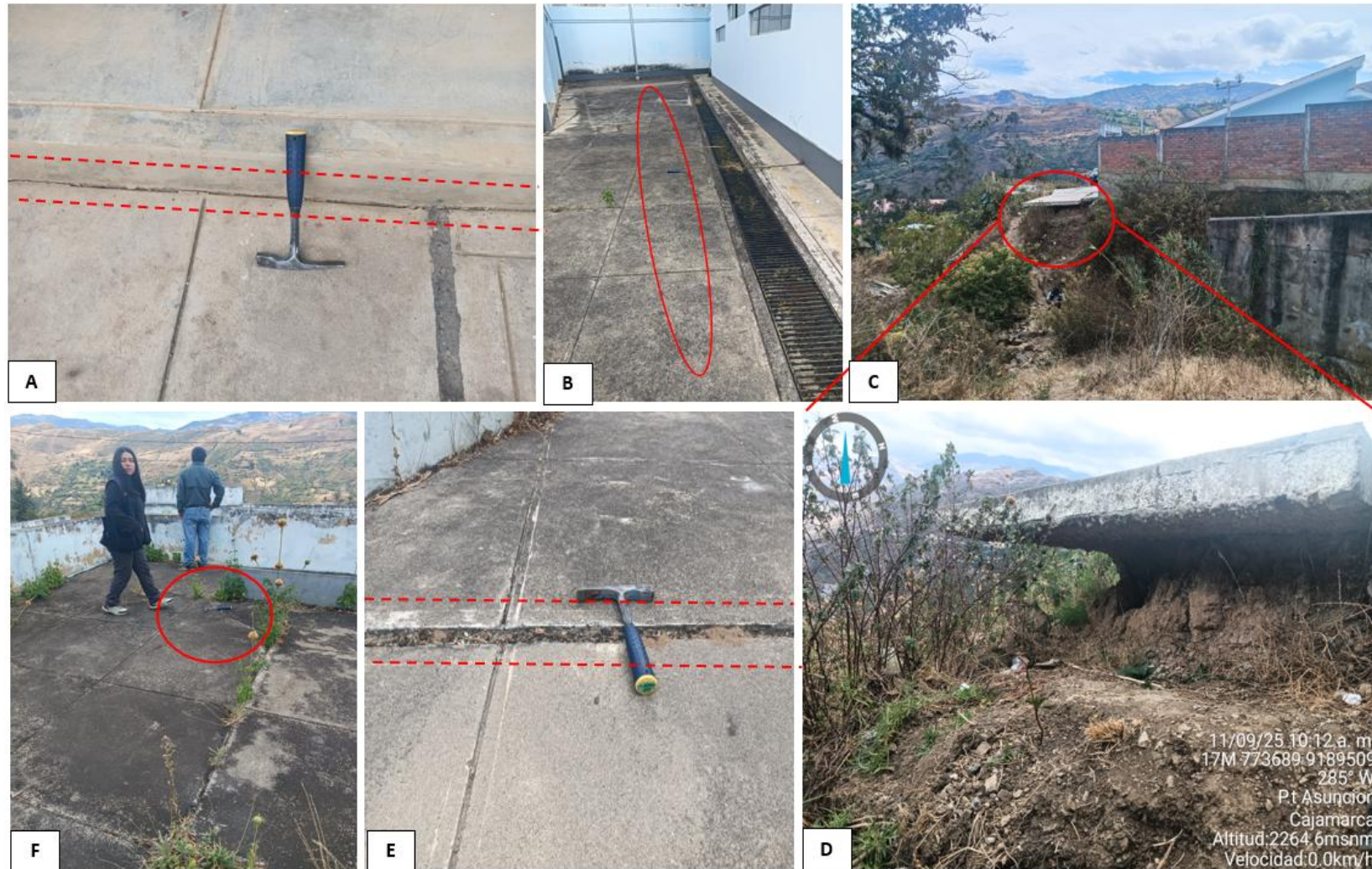
Figura 13. A. Abertura en junta. B. Grietas verticales en piso de Centro de salud, con 3.23 m de longitud. C. Socavación de suelo de fundación de zona frontal de Centro de Salud. D. Socavamiento de 1.05 m. E. Abertura de juntas en el suelo de Centro de Salud. F. grietas en piso de patio colindante a Centro de Salud, con asentamiento.
