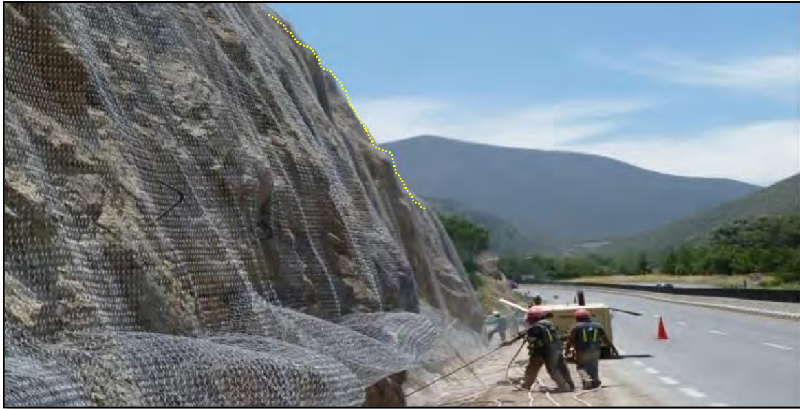
Figura 10. Mallas de protección con anclajes para caída de rocas o derrumbes tanto en detritos como roca alterada, (Vilchez, 2021)
