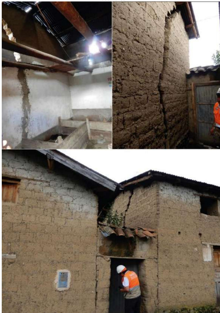
Figura 11: Agrietamientos de viviendas que demostrarían la inestabilidad del suelo por reptación en deslizamientos antiguos.
