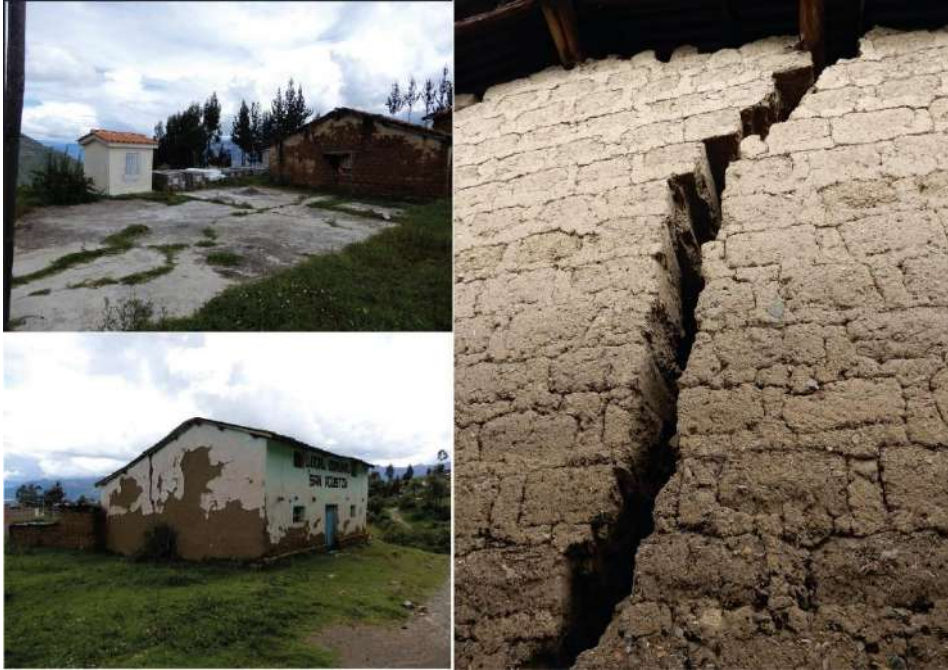
Figura 10: Agrietamientos de viviendas por efecto de reptación sobre cuerpos antiguos de deslizamientos de suelos en Accomarca.
