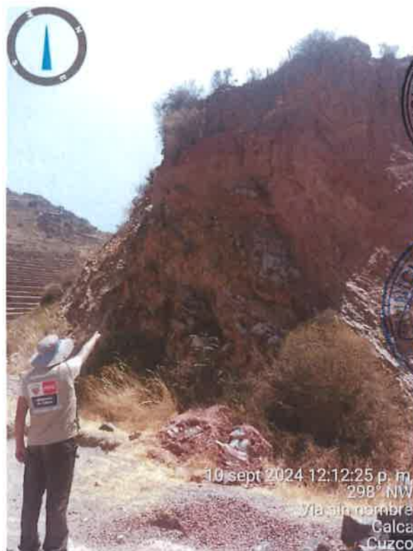
Figura 107. Caída de rocas producto del contacto geológico en las coordenadas 8515926 N, 192378 E en el Parque Arqueológico de Pisac.
