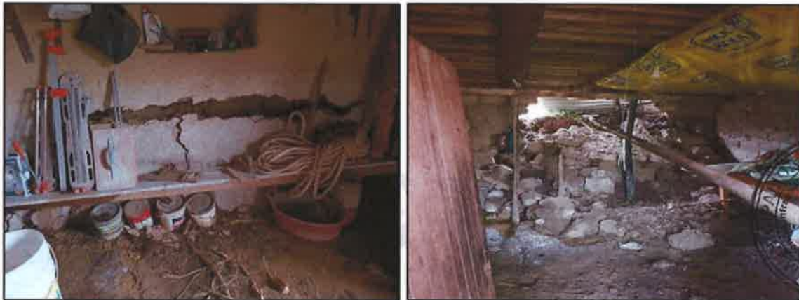
Figura 94. Afectación de viviendas por lluvias intensas en la comunidad de Cuyo Chico 10/03/2025.
