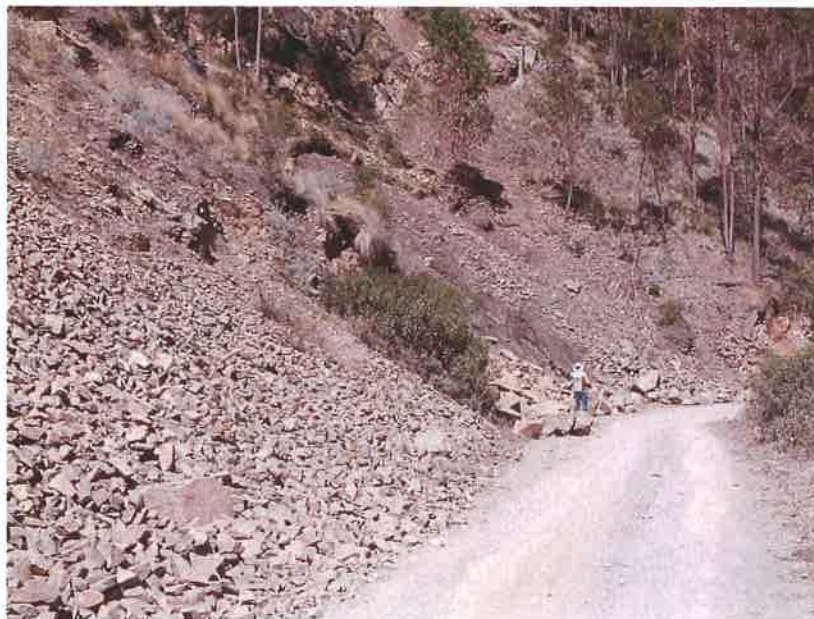
Figura 102. Caída de rocas en el sector de Mujunkuro en la comunidad de Sacaca, vía hacia Pampallacta.
