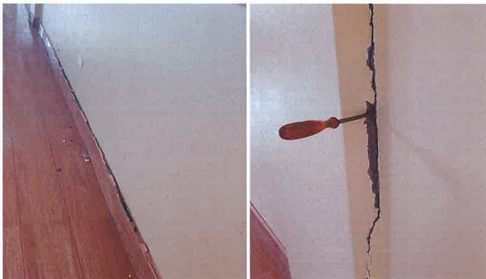
Figura 127. Grietas en el techo y el piso de una vivienda.
