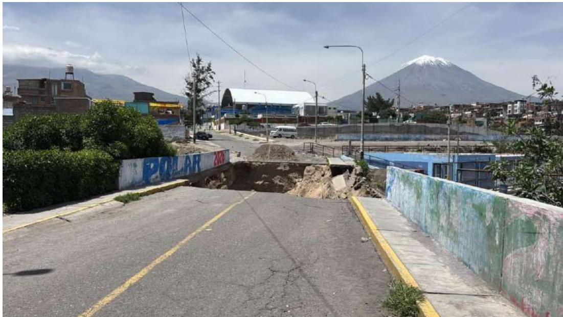
Fotografía 7. Puente Casimiro Cuadros, Buenos Aires (Cayma) colapsado, debido a los flujos de detritos que debilitaron las bases de la estructura.
