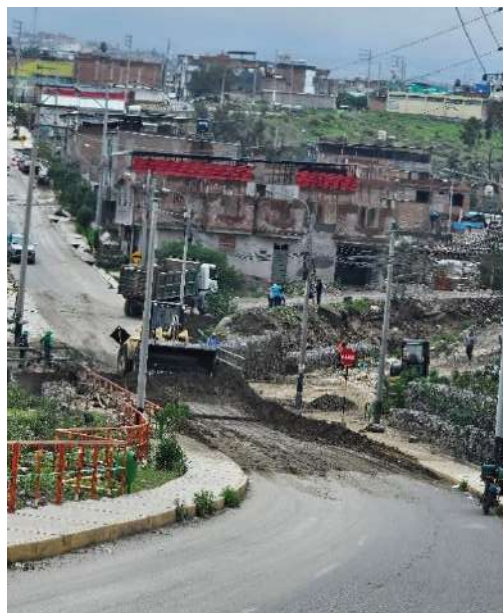
Fotografía 5. Afectación en el sector de Puente que une la Av. 54 con Nazareno, en el sector de Enace (Cayma).
