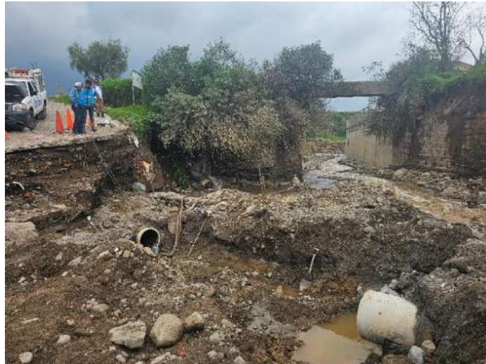
Fotografía 9. Tuberías totalmente destruidas en el sector de Prolongación Lari Lari (Cayma – Cerro Colorado)
