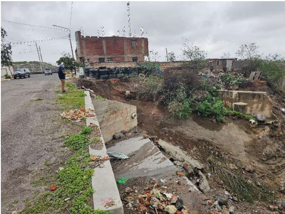
Fotografía 50. Socavamiento de las laderas de la quebrada Añashuayco en el sector del Asentamiento Humano Villa Arequipa (Cerro Colorado).
