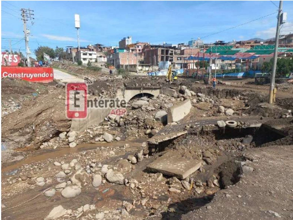
Fotografía 6. Puente de Villa Continental destruido por los flujos de detritos emplazados por la quebrada Chullo. Fuente (Entérate AQP).
