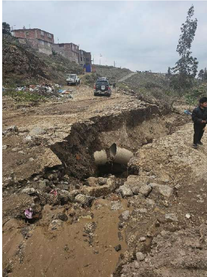
Fotografía 1. Visita del sector Asociación de Vivienda de los Milagros (Cayma), donde carreteras fueron afectadas, tuberías de agua y desagüe destruidas.
