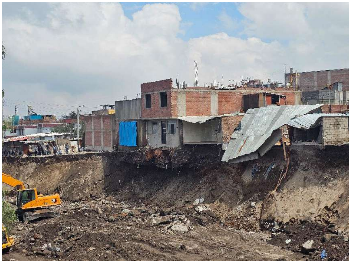
Fotografía 37. Vivienda a punto de colapsar, por el socavamiento del flujo de detritos que se desplazó por la quebrada los Incas en el sector Miguel Grau (Mariano Melgar).
