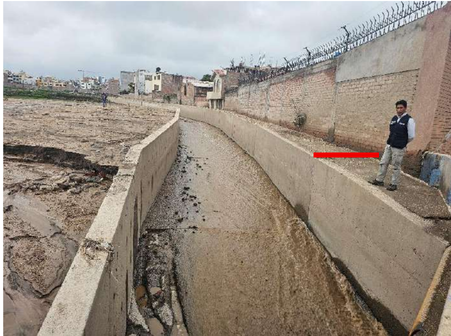
Fotografía 21. Desbordamiento de la quebrada en la bajada de la Av. Chullo (Yanahuara). La línea de color rojo indica el tramo reducido de la quebrada durante las obras de encauzamiento de la quebrada Chullo en el año 2022.
