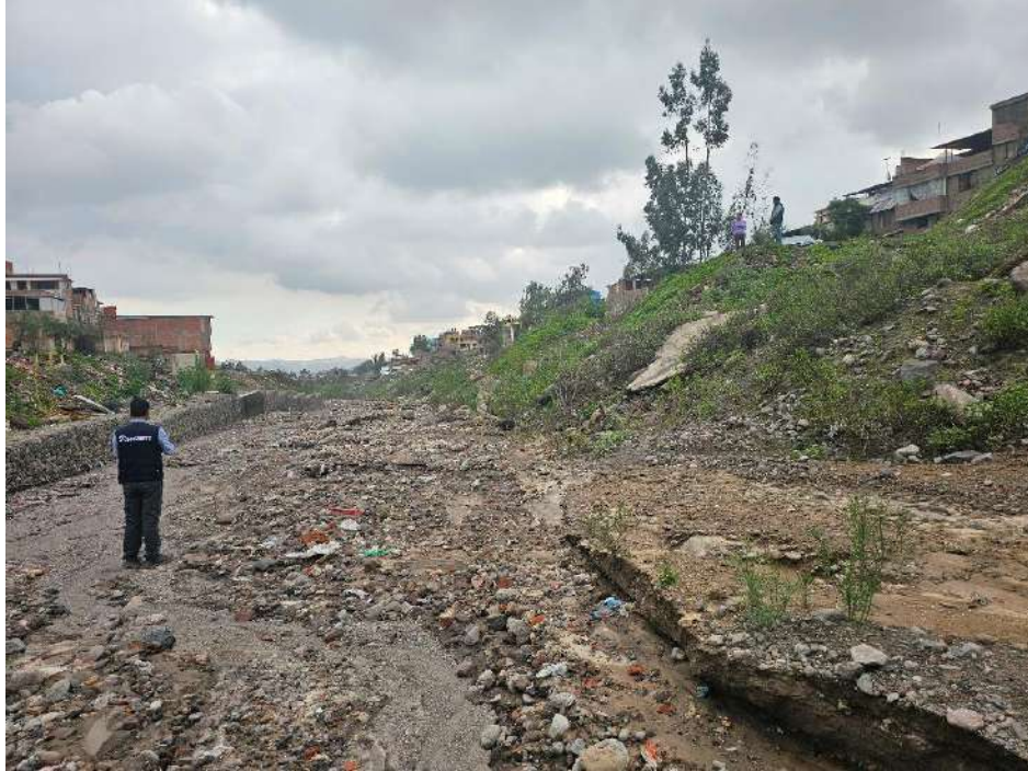
Fotografía 533. Colmatación con material antrópico de la quebrada San Lázaro en el sector de Leones del Misti (Alto Selva Alegre).
