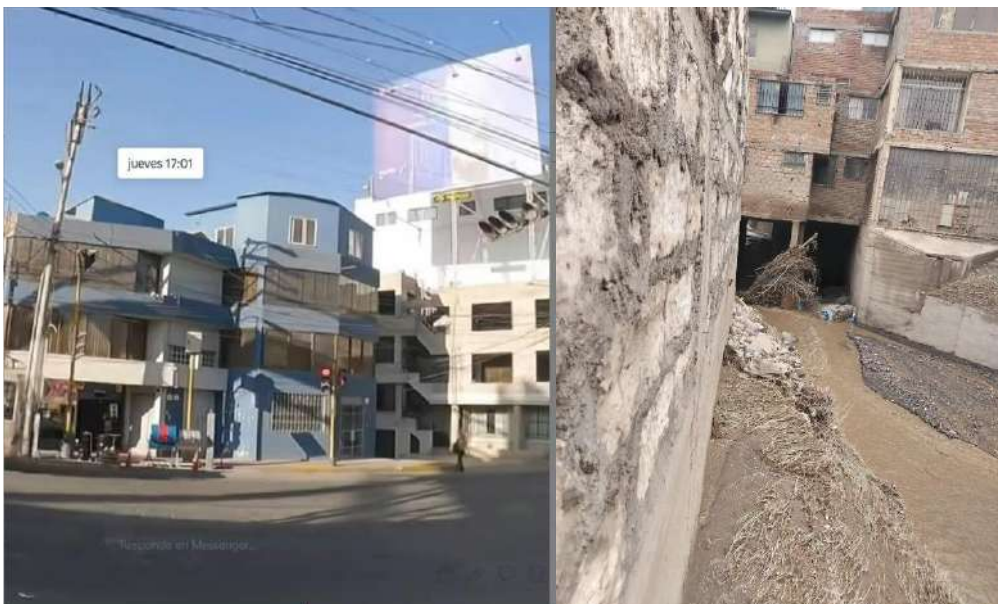
Fotografía 16. Puente del diablo (Cayma). A la izquierda se aprecia casas construidas sobre la misma quebrada Chullo. A la derecha se puede apreciar como el cauce de la quebrada debilita las bases de la construcción. Foto P. Masias.
