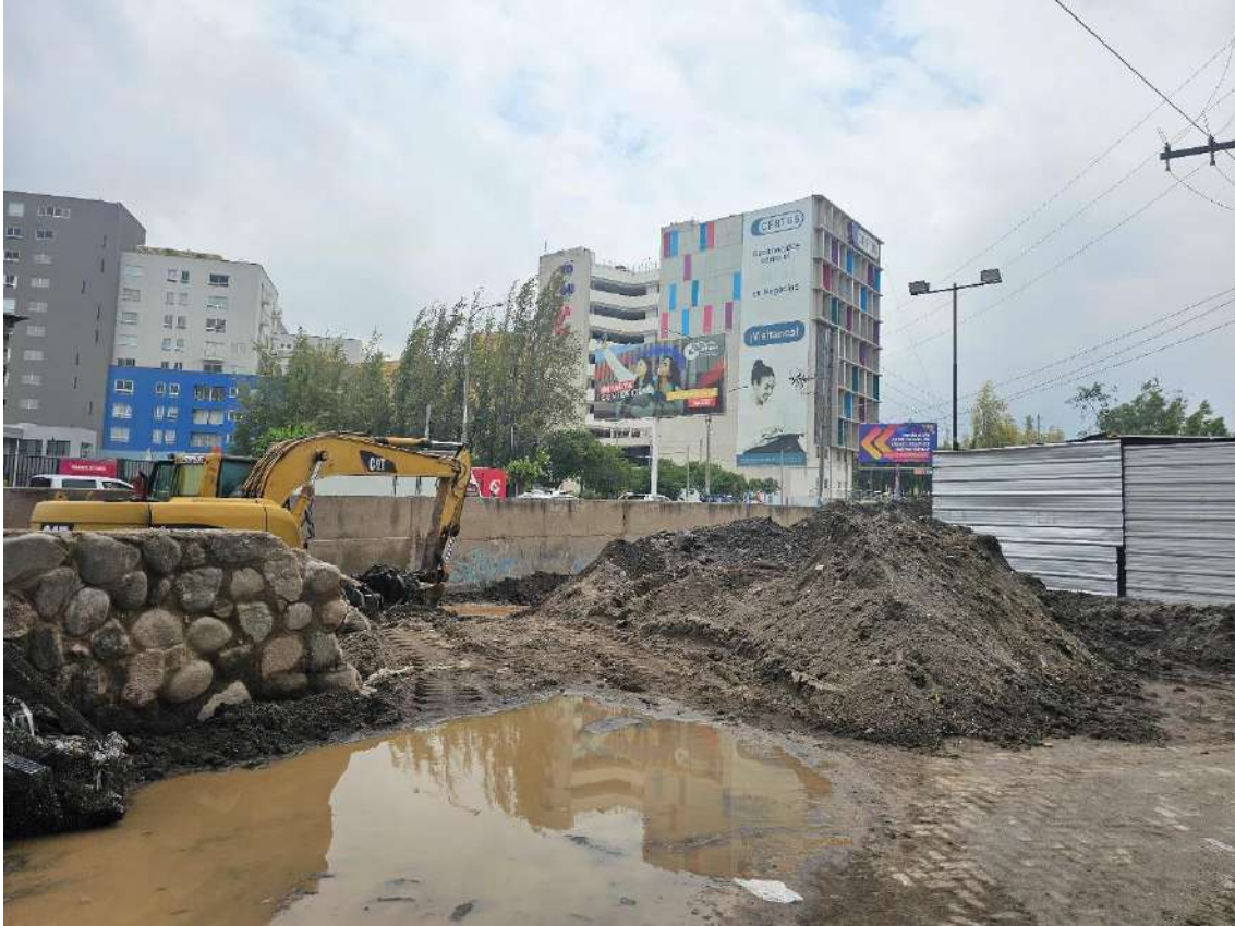
Fotografía 43. Desborde de la quebrada los Incas, que afectó la Universidad Continental de Arequipa, afectando la infraestructura y vehículos (José Luis Bustamante y Rivero). Se puede apreciar que maquinaria se encuentra realizando trabajos de descolmatación.
