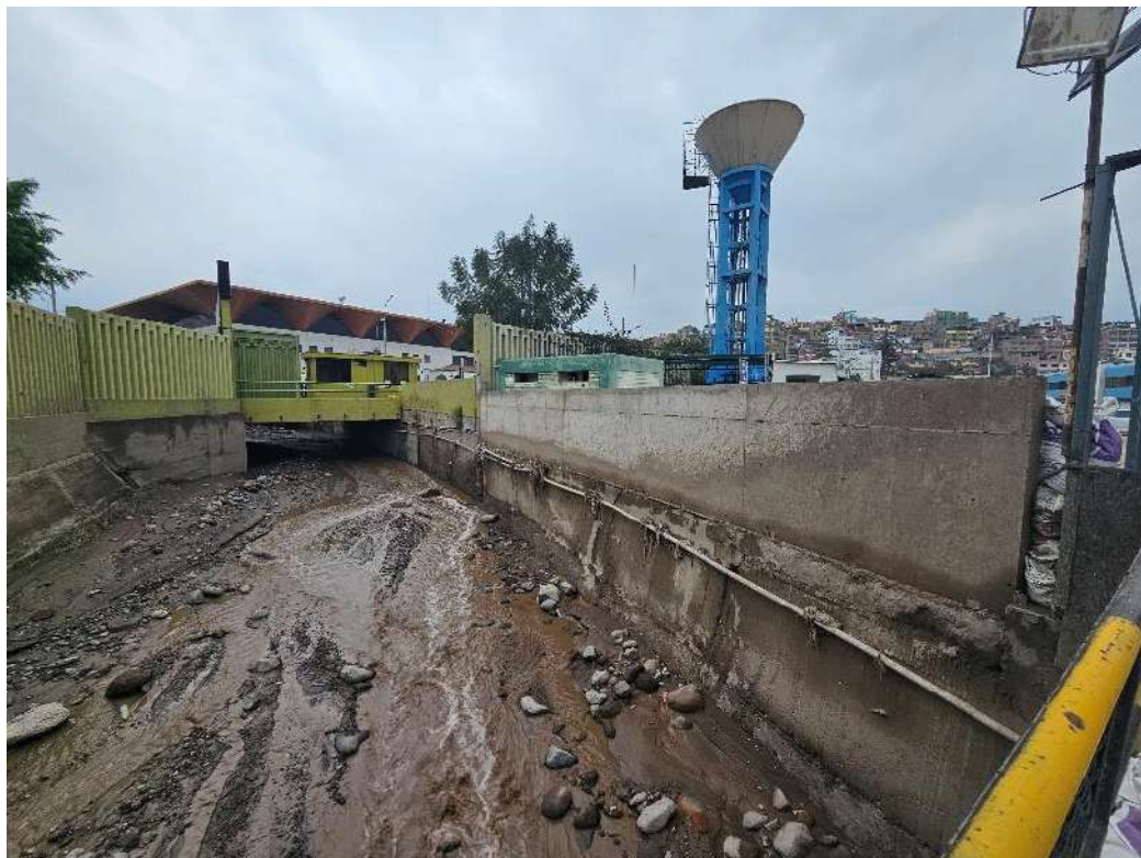
Fotografía 44. Desborde de la quebrada Los Incas, que causó la inundación con lodo en instalaciones del terminal terrestre de Arequipa (Jacobo Hunter).
