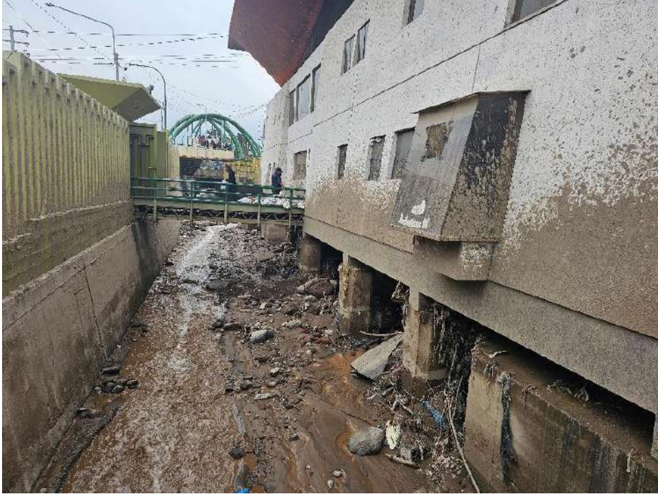
Fotografía 45. Desborde de la quebrada Los Incas, que causó la inundación con lodo en instalaciones del terminal terrestre de Arequipa (Jacobo Hunter).
