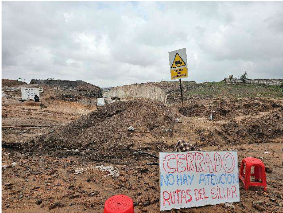
Fotografía 51. Afectación de la Ruta del Sillar, por la entrada y desbordamiento del flujo de detritos de la quebrada Añashuayco (Cerro Colorado).
