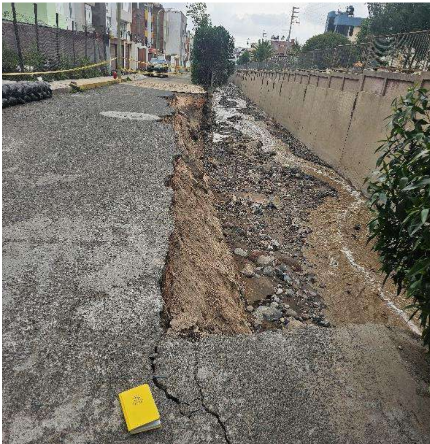
Fotografía 13. Muro de contención caído y grietas en la pista en la Urbanización Mirasol (Cayma).
