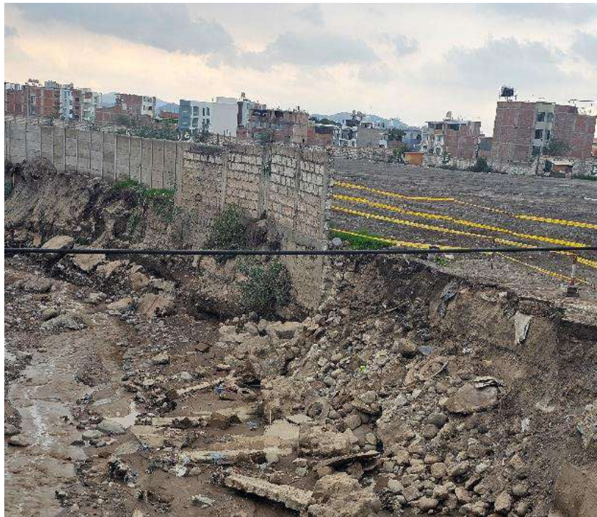
Fotografía 46. Socavamiento de la ladera de la quebrada, que causó la inundación en la parte baja del terminal terrestre de Arequipa, Ernesto Gunther (Jacobo Hunter).
