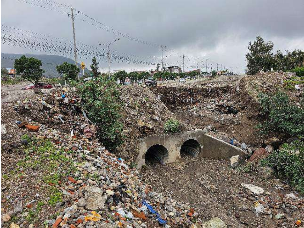
Fotografía 49. Puente Av. 54, donde se puede apreciar que la quebrada se restringe a alcantarillas circulares de 1.5 m de diámetro (Cerro Colorado).
