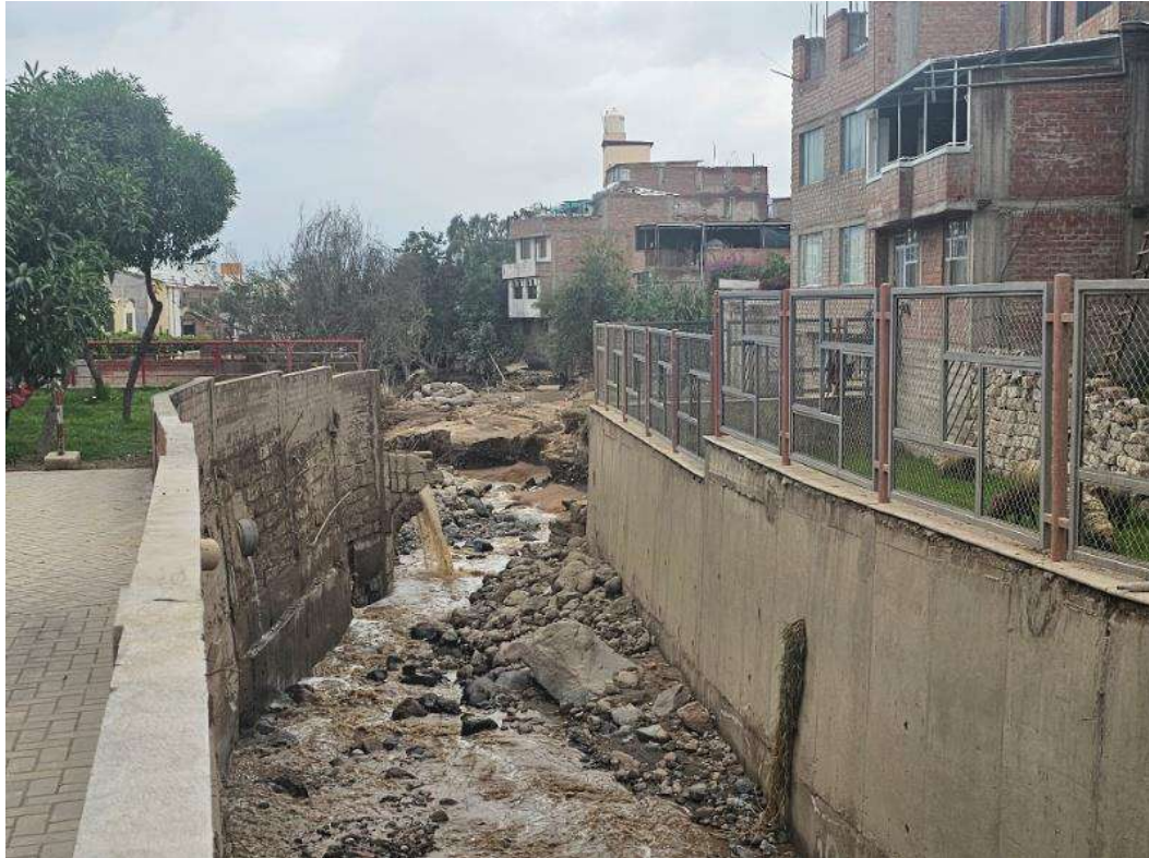
Fotografía 11. Se puede apreciar en la Urbanización Jorge Basadre (Cayma – Cerro Colorado), la quebrada se ha reducido a menos de 10 m de ancho.
