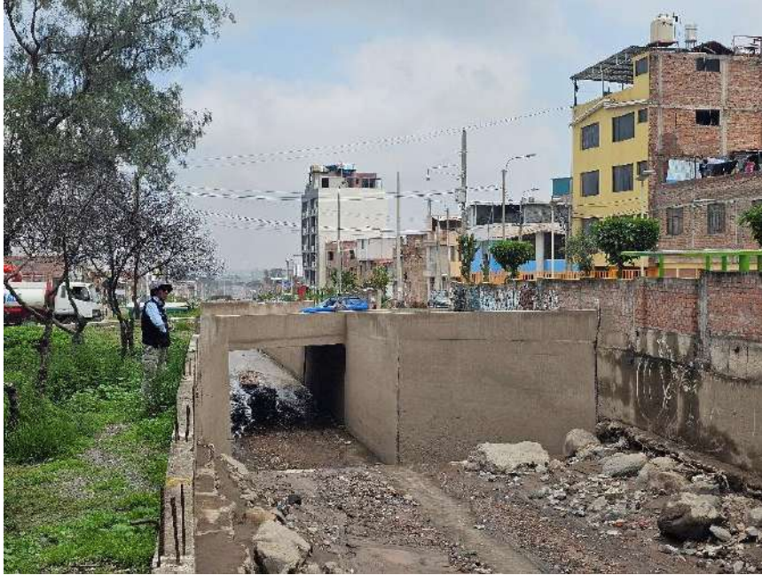
Fotografía 40. Cauce de la quebrada Los Incas se acorta a solo 5 m del puente en sector de Maria Nieves y Bustamante, formando un “cuello de botella” (Mariano Melgar).
