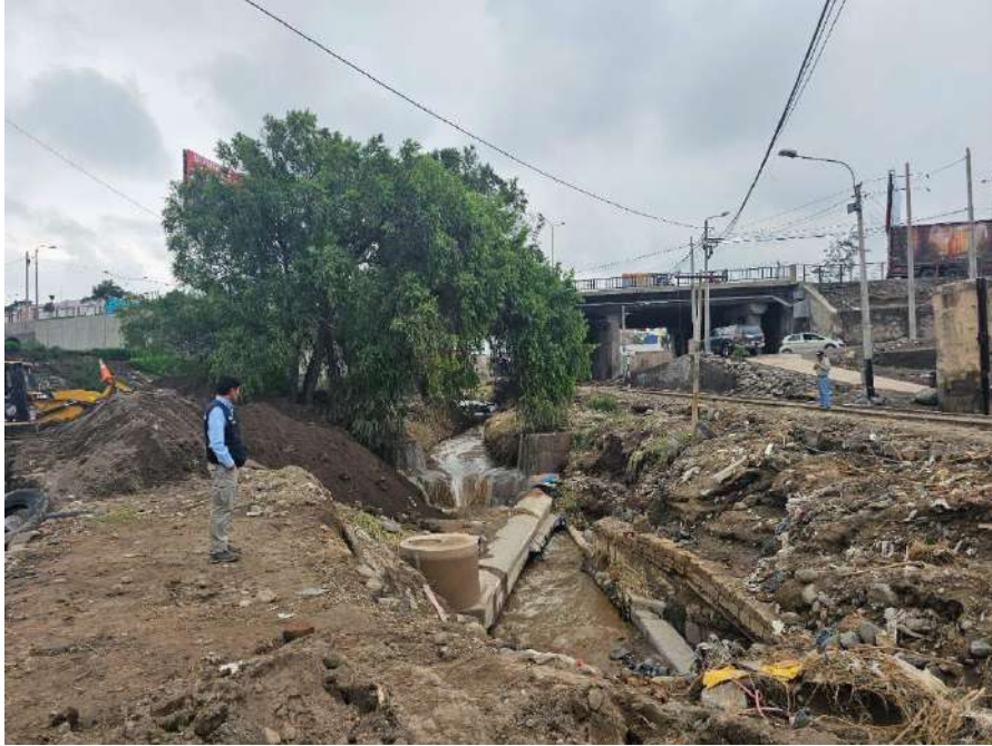
Fotografía 33. Tuberías de agua y desagüe destruidas en la zona de Arrayanes (Cercado de Arequipa).
