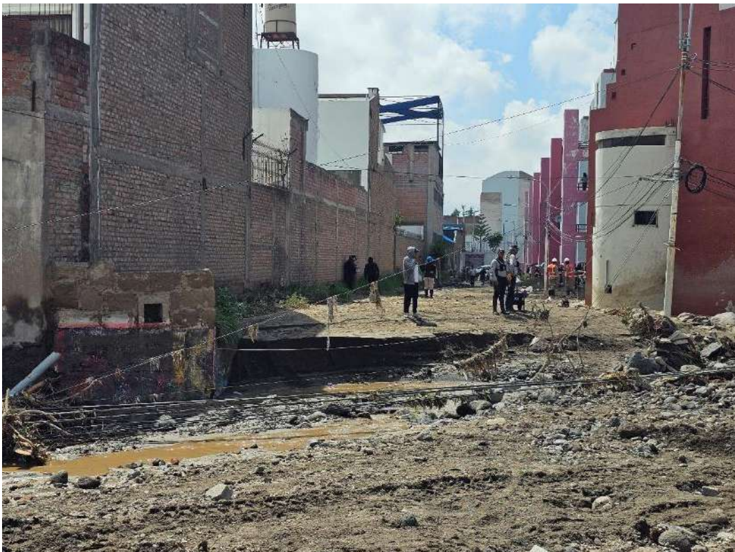
Fotografía 29. Flora Tristán afectada por el desbordamiento de la quebrada Chullo (Cercado de Arequipa). Casas destruidas, vehículos sepultados.
