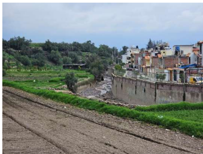
Fotografía 10. Se puede apreciar en el sector de Prolongación Lari Lari (Cayma – Cerro Colorado), que la quebrada se ha reducido a 15 m de ancho.
