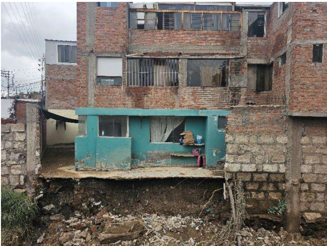
Fotografía 15. Casas acentuadas dentro de en la faja marginal de la quebrada Chullo a punto de colapsar, al frente de la Urbanización Los Frutales (Cayma – Cerro Colorado).
