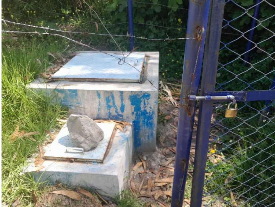
Fotografía16.Vista frontal de la captación de agua para Mallhuapampa, se ubica a 2.5 km aprox. de la plaza, cuenta con un cerco perimétrico con enmallado metálico.
