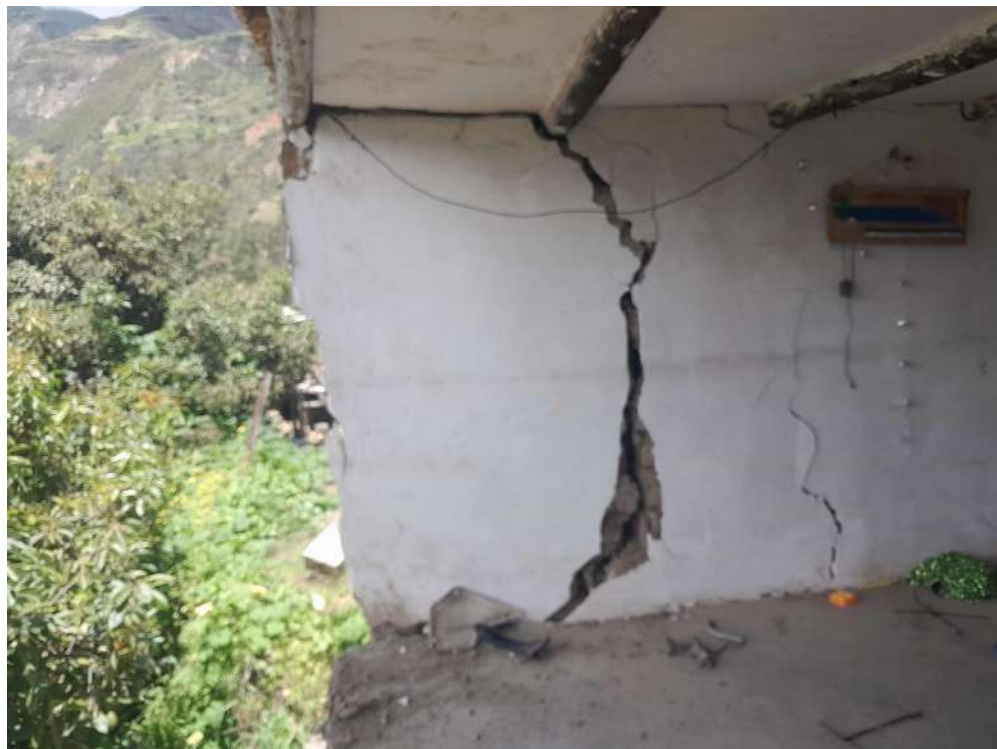
Fotografía22. Vista de vivienda que poseen paredes con grietas, así como viviendas destruidas como producto del evento ultimo de deslizamiento.
