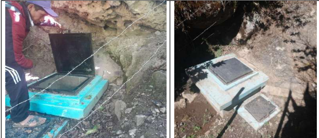
Fotografía14. Vista frontal de la captación de agua para Rampac Chico, se ubica a 2 km aprox. de la plaza, cuenta con un cerco perimétrico con enmallado de alambres.
