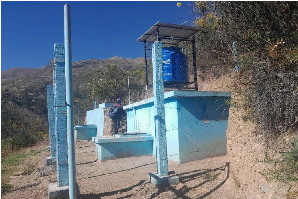
Fotografía15. Vista lateral del reservorio de agua para consumo de la población de Rampac Chico, se ubica a 2km S aprox. de la plaza, cuenta con un cerco perimétrico con enmallado metálico se encuentra parcialmente afectado por el deslizamiento presenta grietas en el cerco perimétrico.
