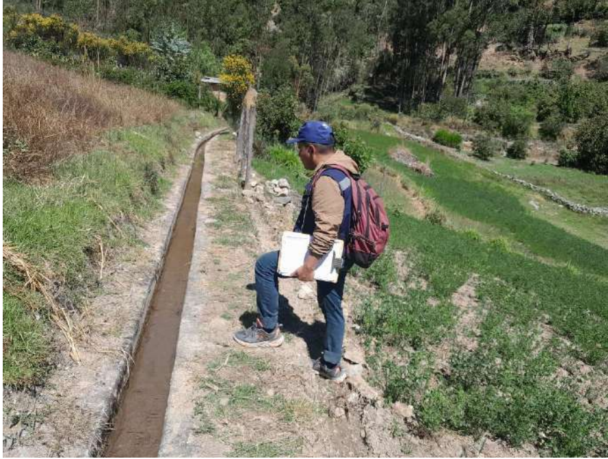
Fotografia13. Canal de regadío del sector Mallhuapampa, canal de revestimiento de concreto en muy mal estado debido a presencia de grietas y fisuras.
