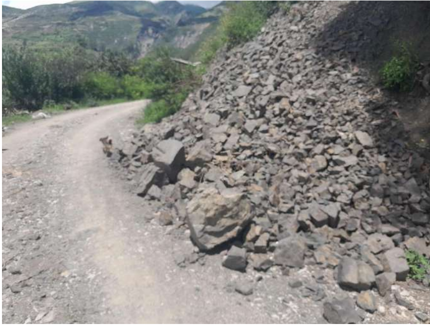
Fotografia31.Vía vecinal afectada en Rampac chico por movimiento en masa.
