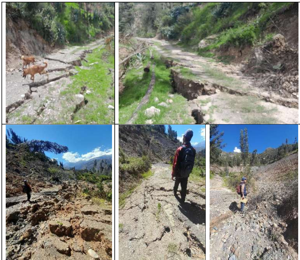
Fotografia32.Trocha carrozable destruido dentro de la localidad de Rampac Chico.
