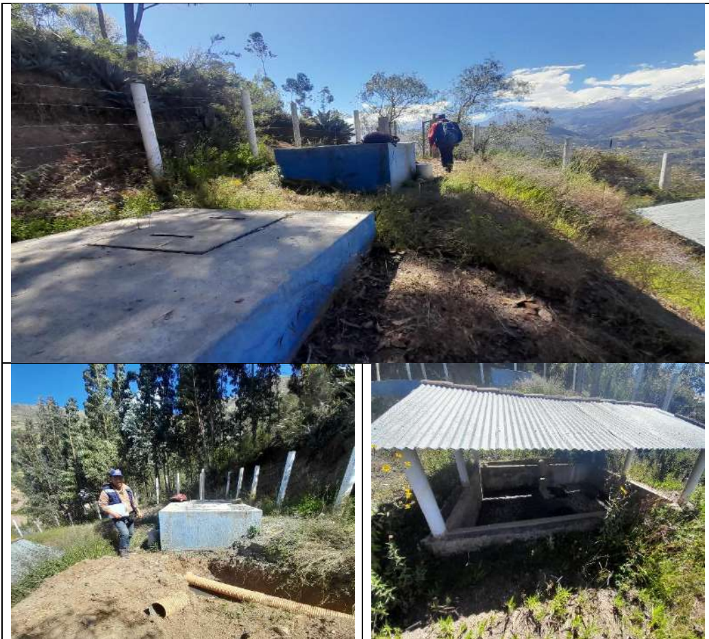
Fotografía18. Vista frontal del pozo séptico ubicado a 500m W aprox. de la plaza de Rampac Chico, como se observa en la fotografía recibió daños en el evento de deslizamiento último.
