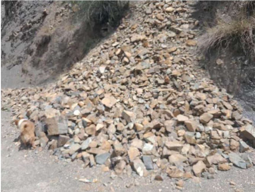
Fotografía7. Pequeños derrumbes en el corte de la carretera en la zona de Rampac Chico.
