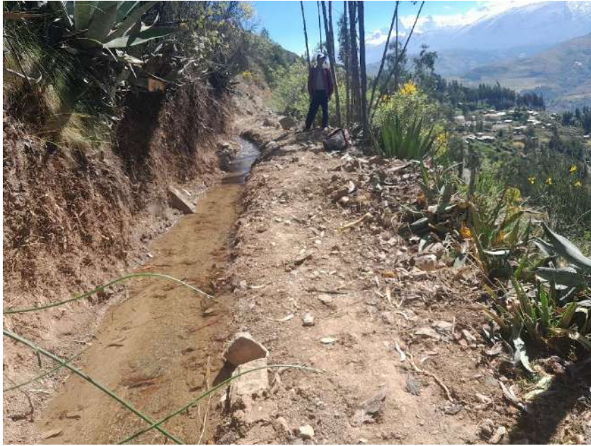
Fotografia11. Canal de regadío Muichi Uran, zanja de tierra que no cuenta con algún tipo de revestimiento debido a la destrucción del material de concreto por evento de deslizamiento.
