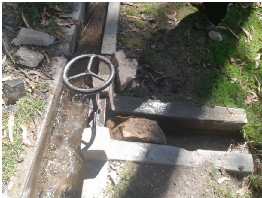
Fotografia12. Compuerta de regadío Muichi Uran, se encuentra en mal estado.
