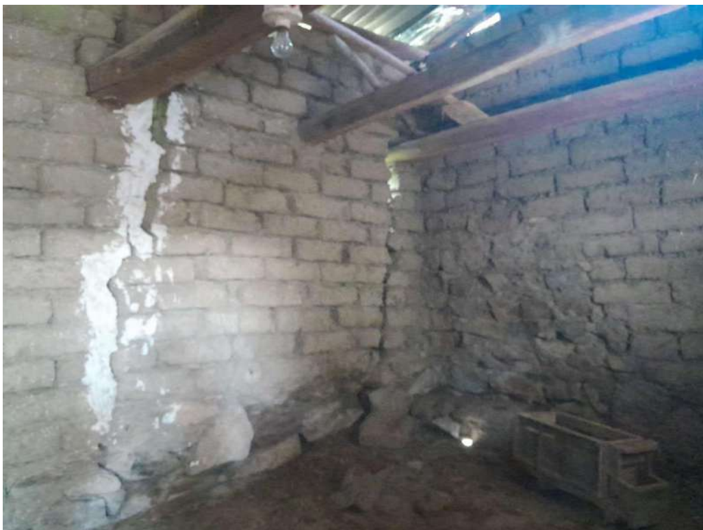
Fotografia22. Vista de viviendas que poseen paredes con grietas, así como viviendas destruidas como producto del evento ultimo de deslizamiento.
