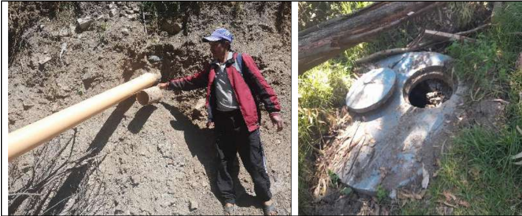
Fotografía18. Vista frontal del Buzón de desagüe y biodigestor a 300 m SE aprox. Del sector Cochac de la localidad de Rampac Chico, se encuentra destruidos como producto del último evento de deslizamiento.
