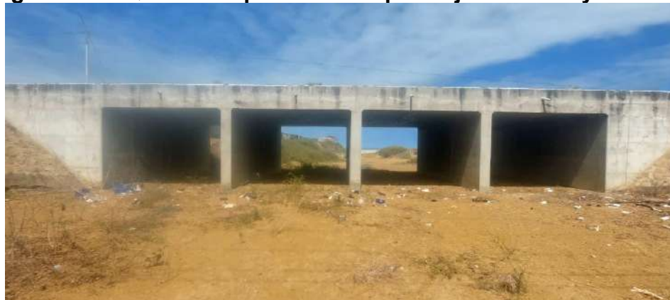
Figura N° 6. Quebrada que se activa por flujo de lodos y detritos.
