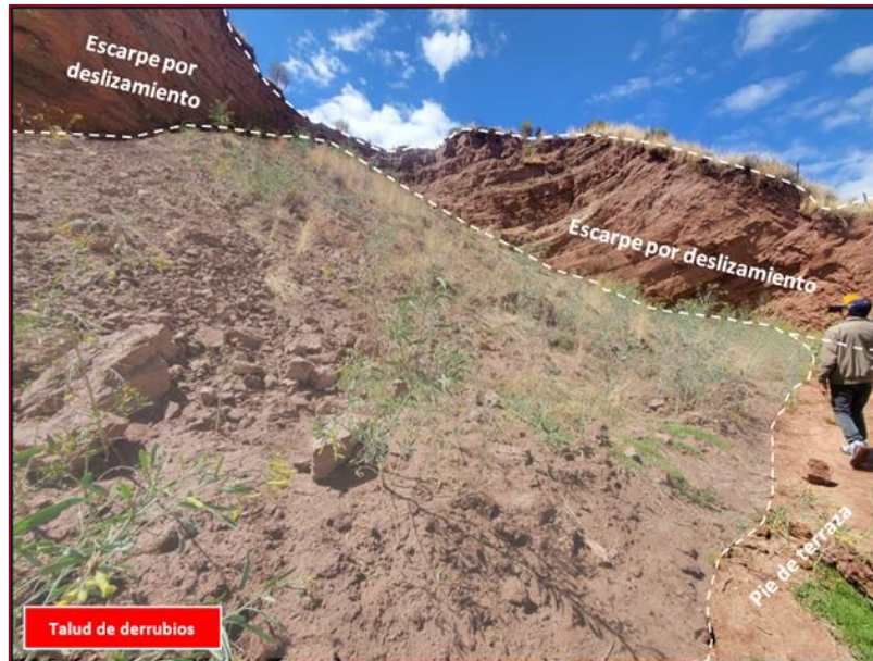
Figura 20: Talud de derrubios producto de deslizamientos
