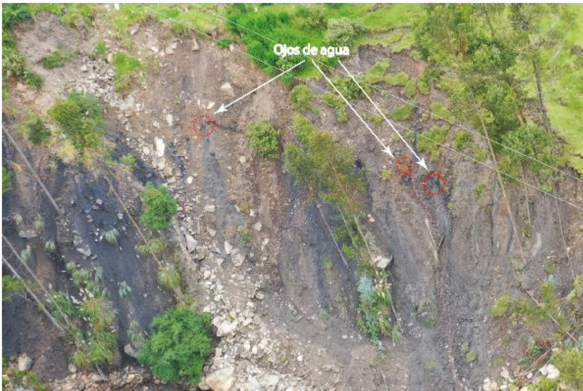
Figura 15. Vista de ojos de agua distribuidos a lo largo del talud afectado por derrumbes, lo cual demuestra la sobresaturación del terreno y se muestra la erosión que provoca.
