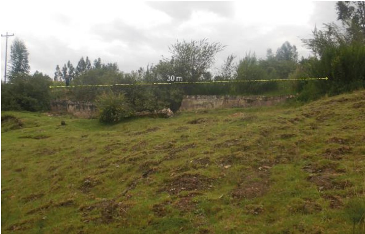
Figura 11. Vista del muro de contención de concreto de 30 m de longitud, ubicada a 6 metros ladera abajo de la vía Cayas-Colcas, actualmente presenta grietas en su estructura y destruida por partes.
