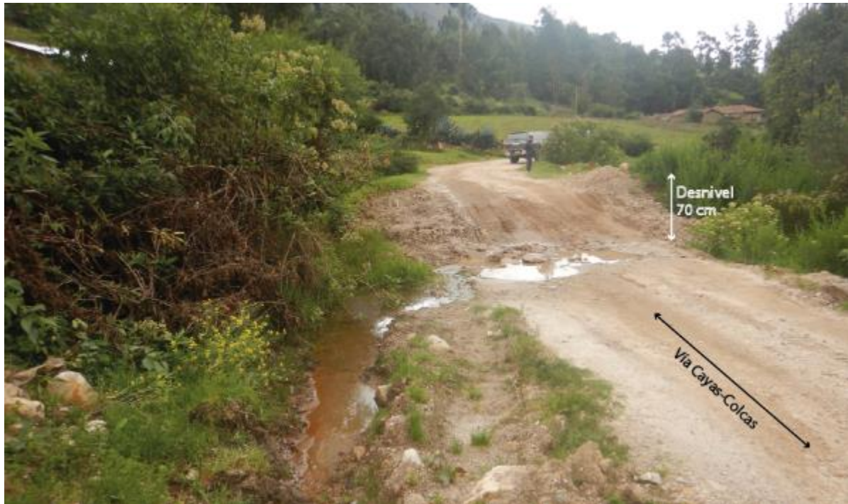
Figura 7. Vista del desnivel de 70 cm sobre la vía Cayas-Colcas que corresponde al flanco izquierdo del deslizamiento rotacional activo, ubicado con coordenadas 262302 E; 8970071 N.
