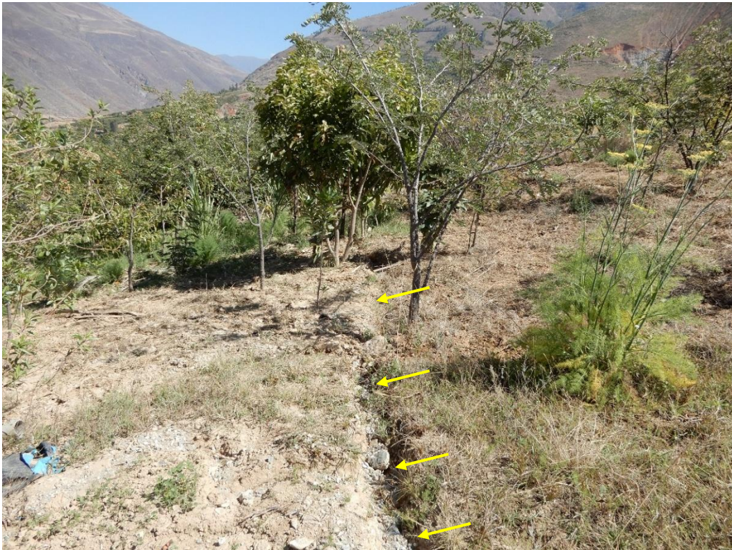
Fotografía 10. Canales sin revestir (indican flechas amarillas) para riego de cultivos frutales. Estos canales se encuentran encima de la corona del deslizamiento activo.
