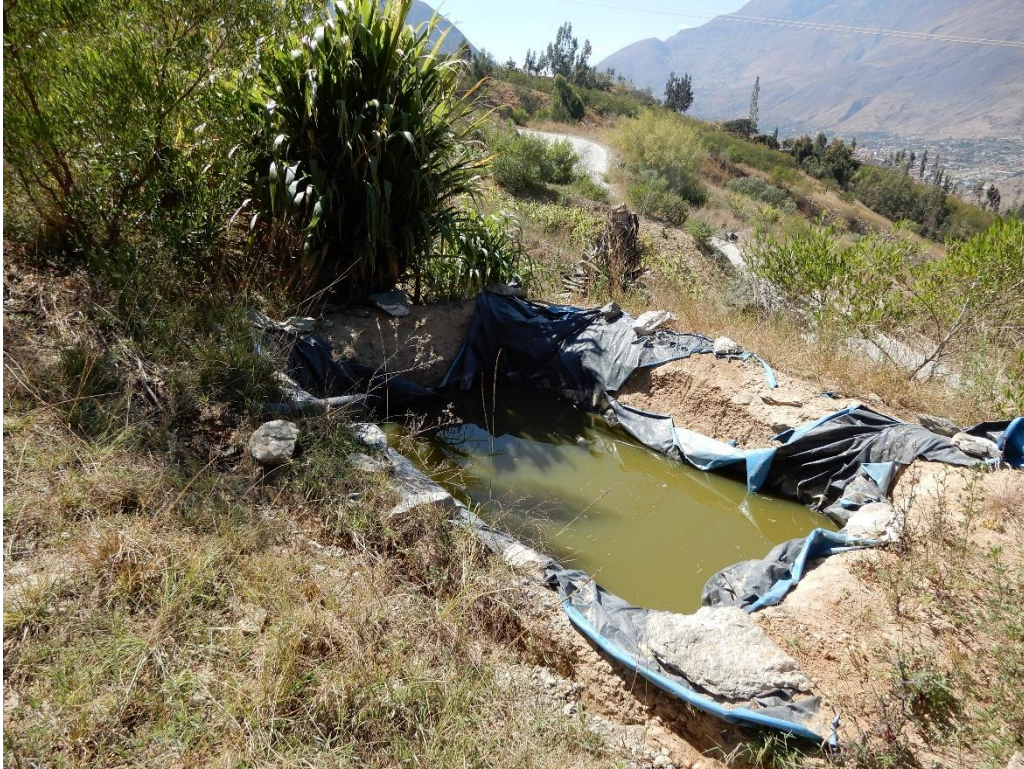
Fotografía 12. Reservorio artesanal de 3 m x 1.5 m sin revestir para el almacenamiento de agua, ocasionan sobresaturación del suelo. Se ubica a 25 m de escarpe principal del deslizamiento activo.
