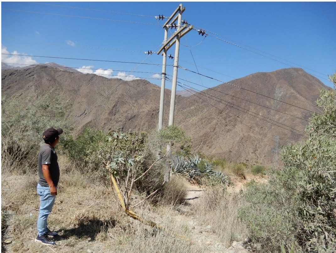
Fotografía 9. Postes de tendido eléctrico de alta tensión ubicados encima de la corona del deslizamiento activo que posiblemente podrían ser afectados por el avance retrogresivo.
