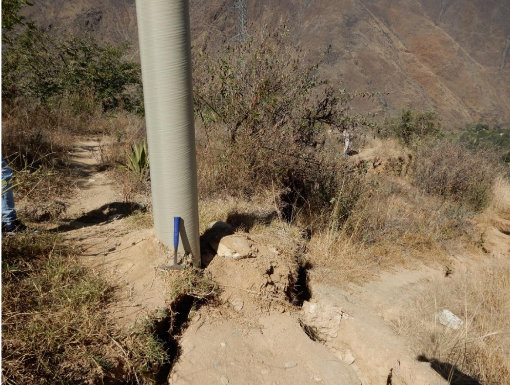
Fotografía 8. El escarpe ocasionó daños en la base del cemento del poste de tendido eléctrico, en el sector Pachabamba.
