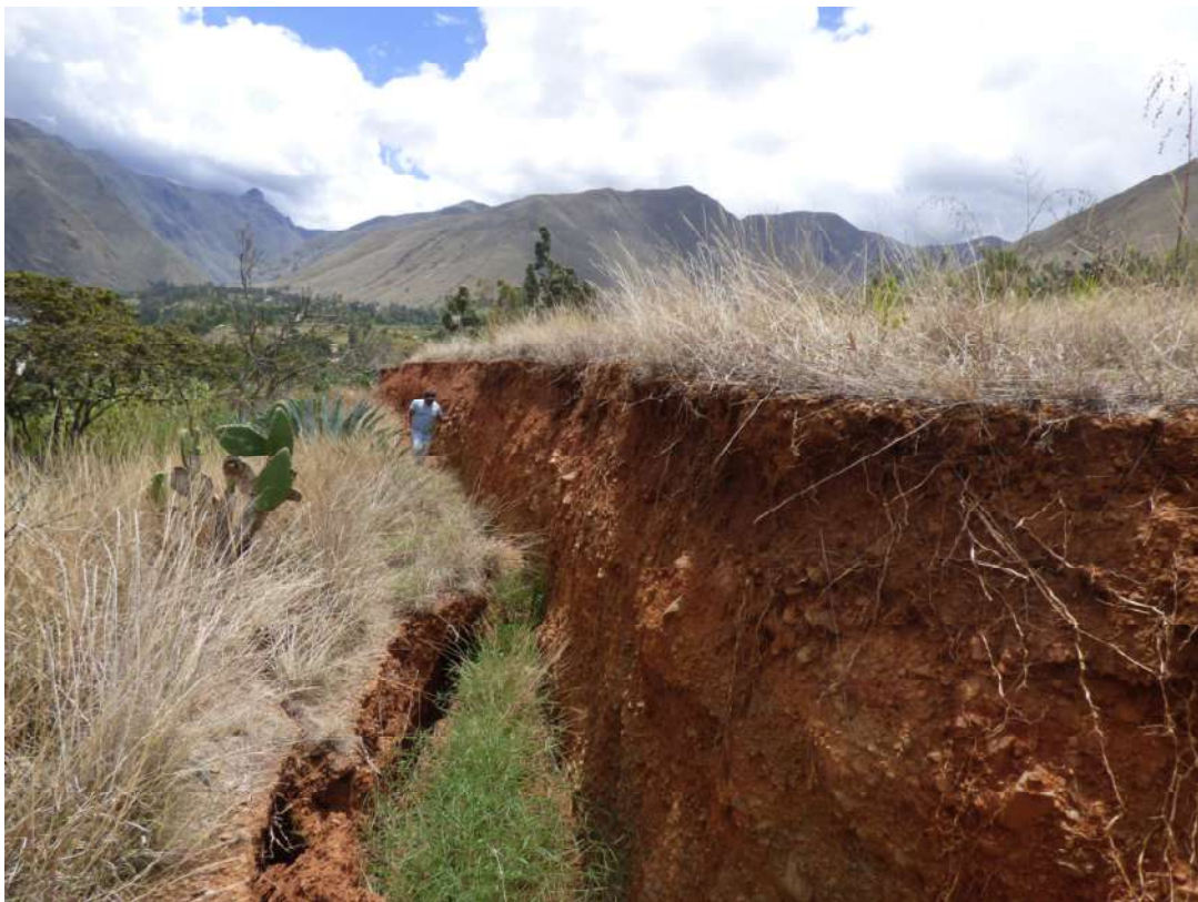
Fotografía 3. Detalle del flanco derecho del deslizamiento con respecto a la dirección del movimiento, donde se observa el salto vertical de hasta 4 m del escarpe principal. Vista en dirección suroeste.
