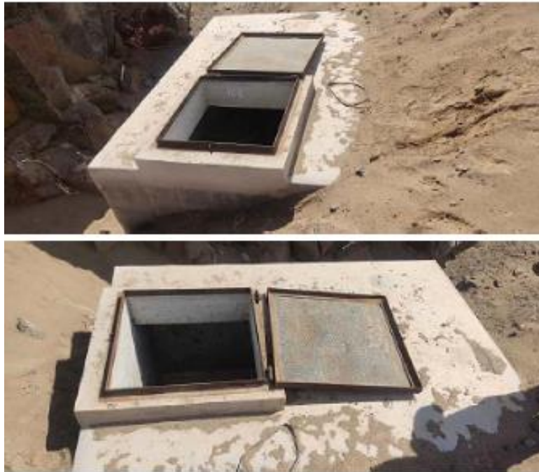
Fotografía N° 10 Estado situación del Buzón 05,
