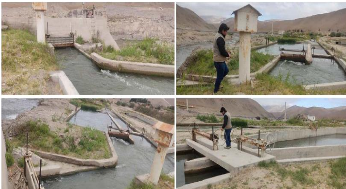
Fuente: Equipo técnico de Evaluación de Riesgos
